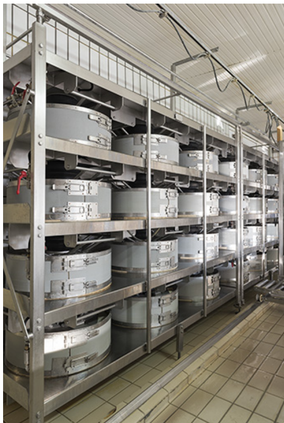
Atelier de fabrication : installation de pressage pneumatique.
