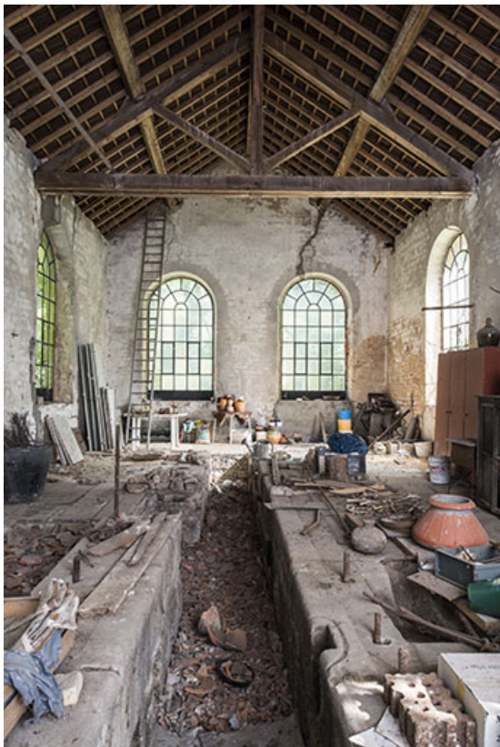
Intérieur de la salle de la machine à vapeur. 25, Chevroz chemin de l' Île
