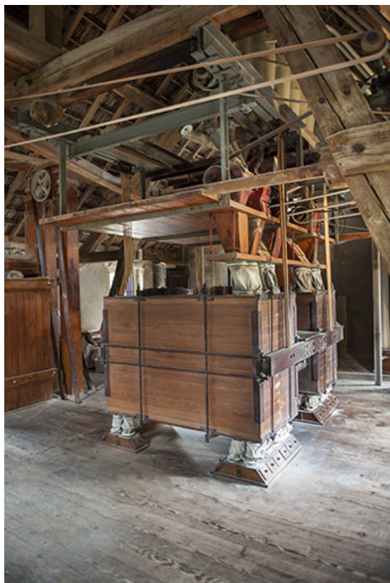
Troisième étage. Plansichter double Néhlig, Heuser et Cie. 25, Liesle, lieudit : le Moulinot
