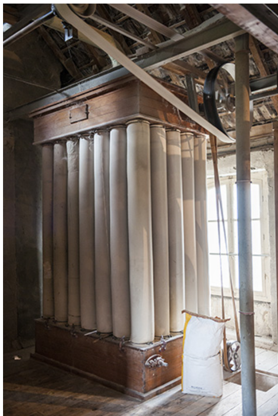
Troisième étage. Filtre à air.
