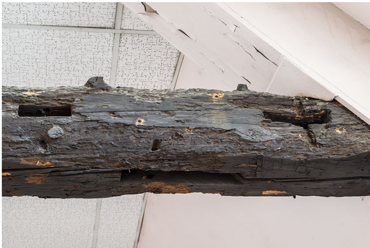
Etage en surcroît, partie droite : état d'un entrain de la salle de danse.
