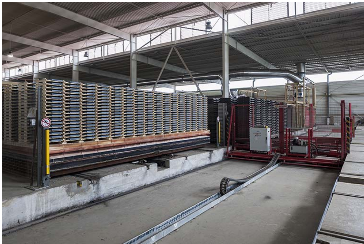
Unité de fabrication dite UL 5. Chariots du four piscine. 25, Lantenne-Vertière route de Mercey
