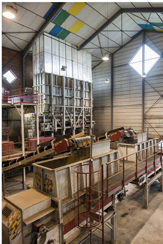
Partie sud de l'unité de préparation des terres. Au premier plan, doseurs-tampon. Au second plan, cellules des doseurs (pesée et brise-mottes).
