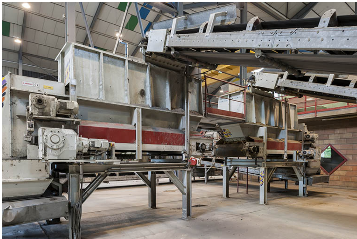
Unité de préparation des terres. Doseurs-tampon.
