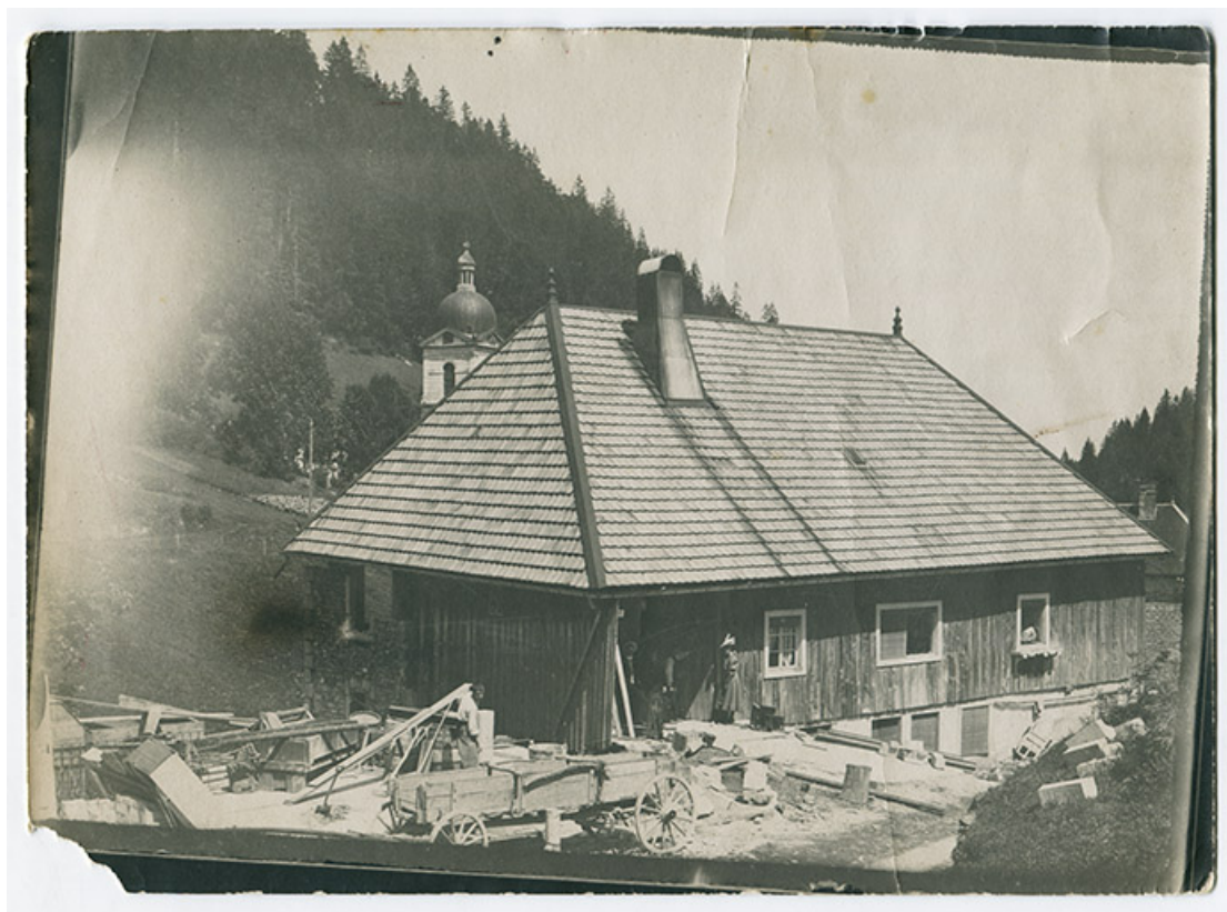
[La fonderie de cuivre Mesnier, en cours de reconstruction : façades antérieure et latérale gauche de l'immeuble], [1906 ou 1907]. 25, Les Gras, 4-6 rue du Moulin
