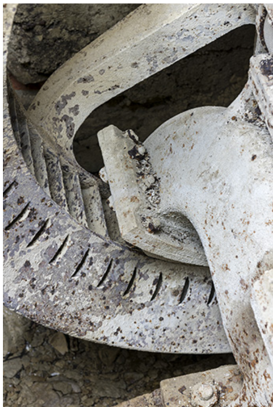
Usine : arrivée d'eau sur les aubes de la turbine. 25, Les Gras, 11-15 Grande Rue
