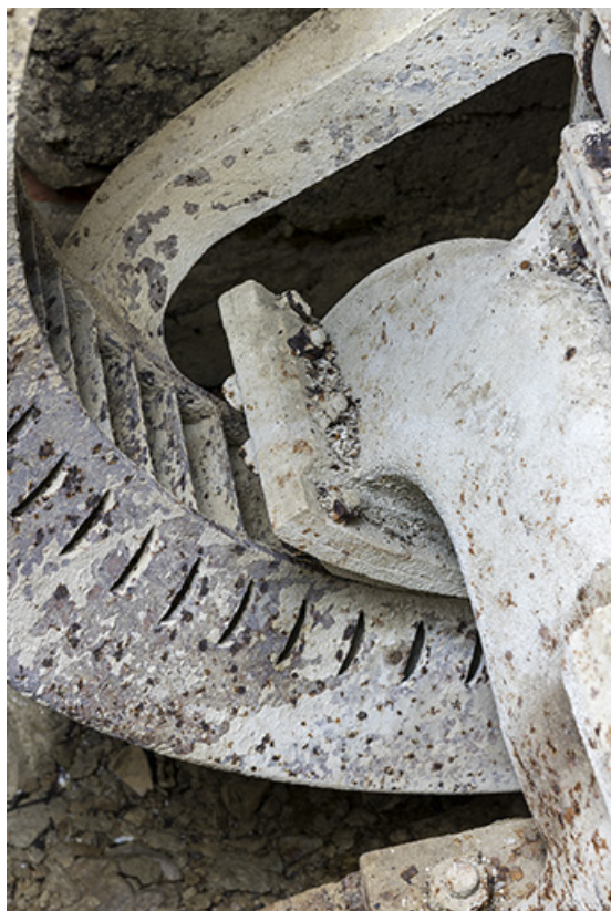
Usine : arrivée d'eau sur les aubes de la turbine. 25, Les Gras, 11-15 Grande Rue
