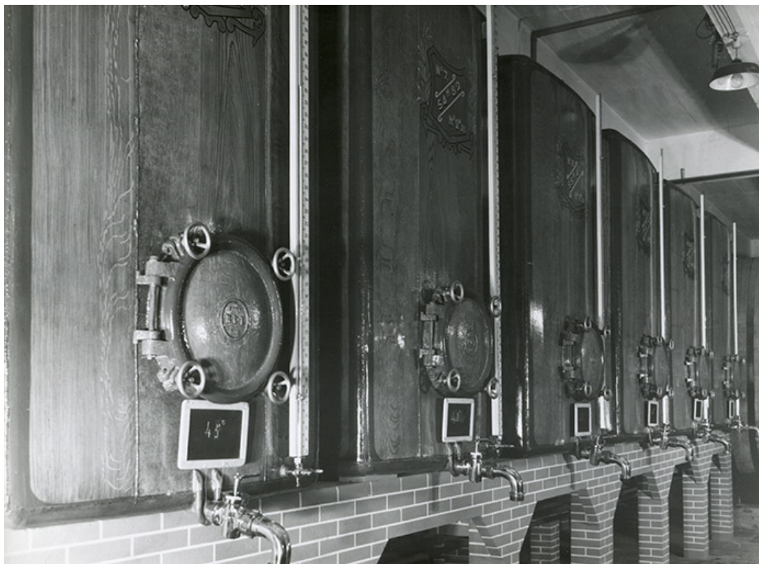
Cuves de stockage de l'apéritif anisé, fotogr., s.d. [milieu 20e siècle]. 25, Pontarlier, 3-5 rue de la Paix
