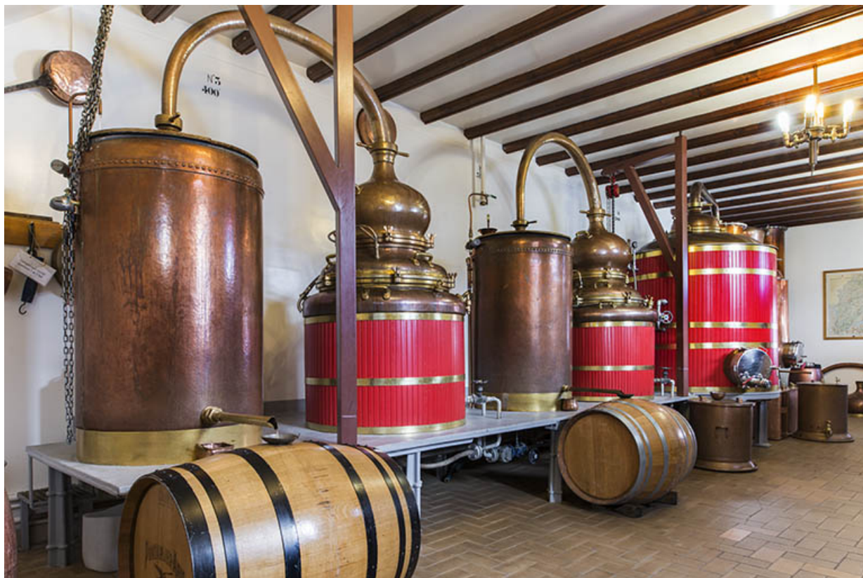
Salle de distillation. Vue d'ensemble.
