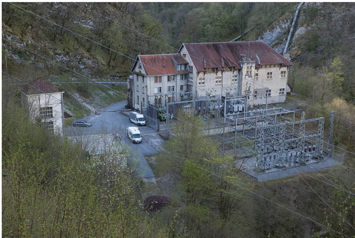
Vue de trois quarts arrière du bâtiment d'exploitation. Poste de transformation au premier plan.
