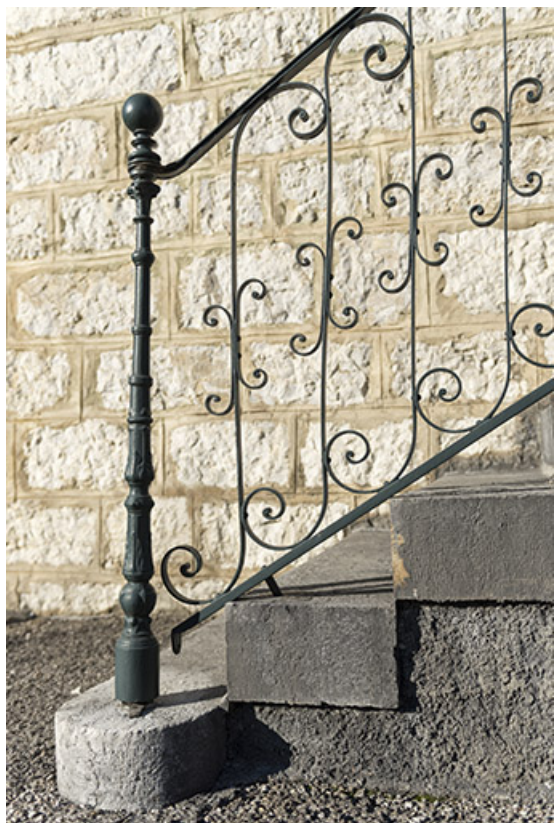
Façade antérieure : garde-corps de l'escalier.
