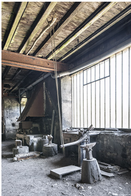
Equipements divers situés contre la façade nord de l'atelier. 25, Nans-sous-Sainte-Anne rue du Four
