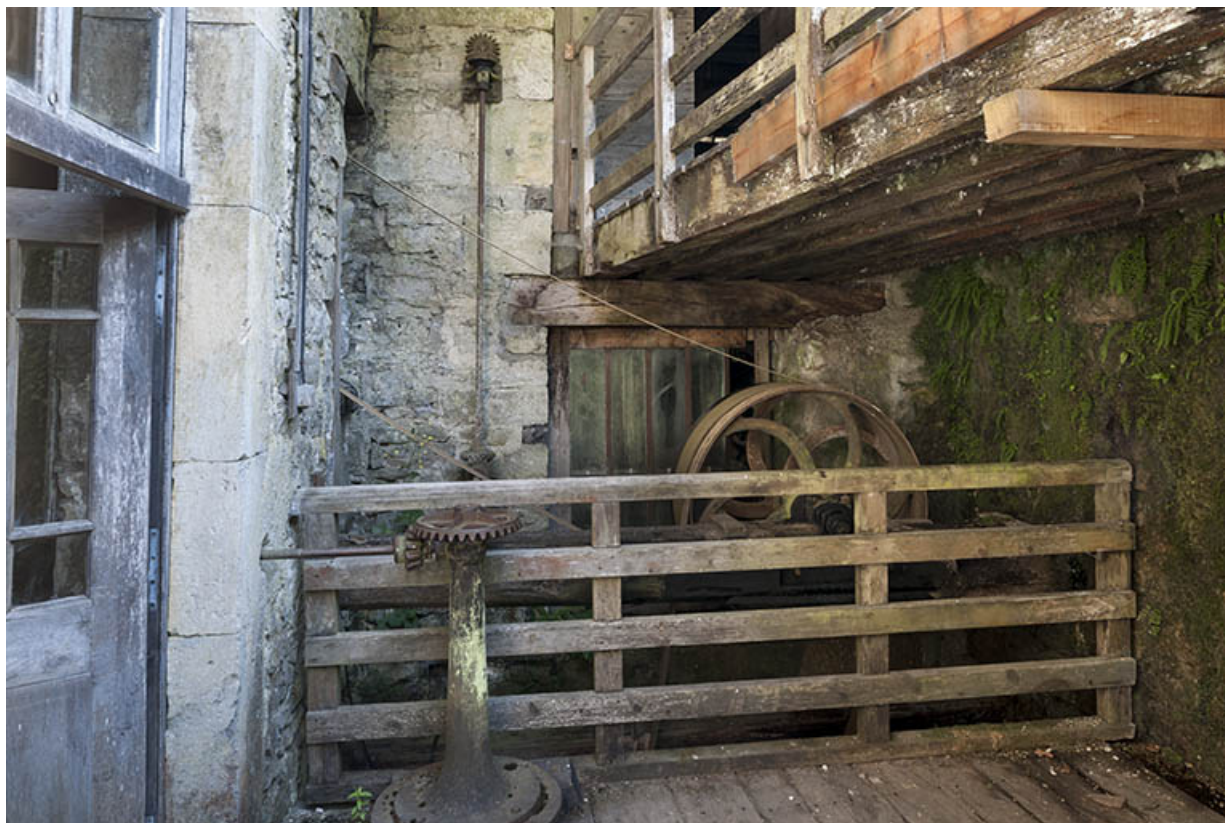
Aplomb de la turbine hydraulique, transmission par courroie et système de contrôle de l'admission d'eau. 25, Nans-sous-Sainte-Anne rue du Four
