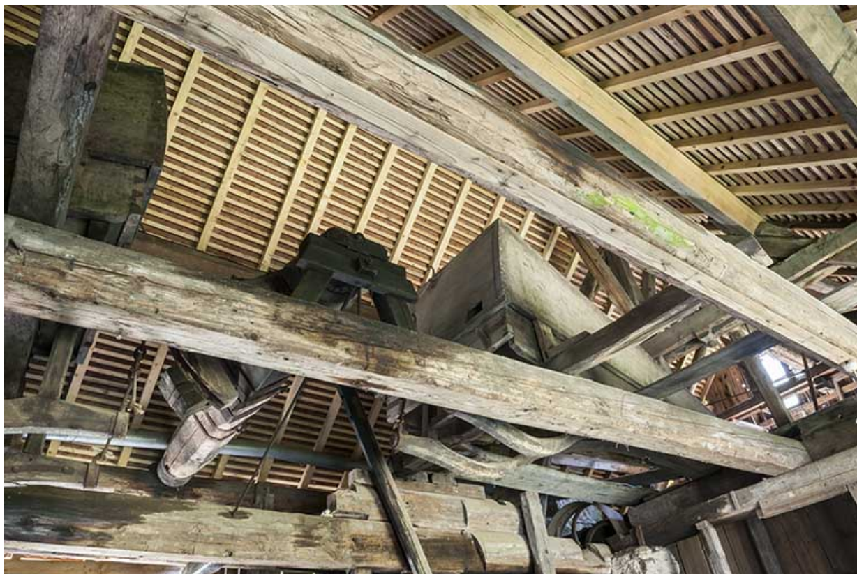
Pièce de la machine soufflante. Mécanisme de transmission et caisson sud.
