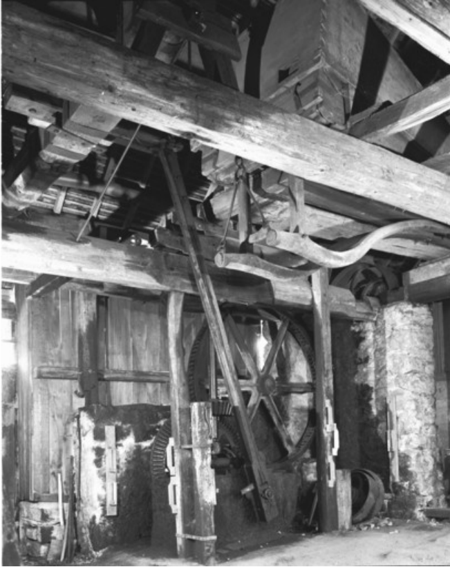
Vue rapprochée des mécanismes et des soufflets de trois quarts gauche. 25, Nans-sous-Sainte-Anne rue du Four
