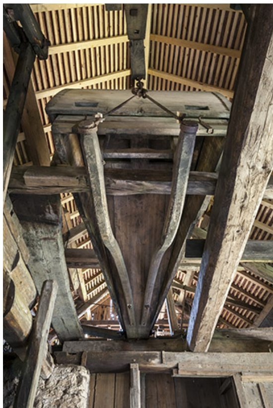
Vue du caisson sud de la machine soufflante.
