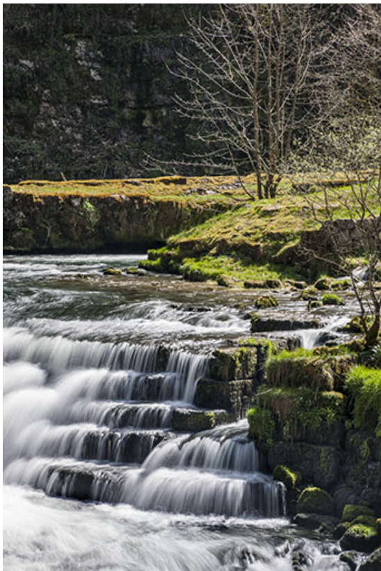
Chute sur l'ancien barrage du moulin dessous.
