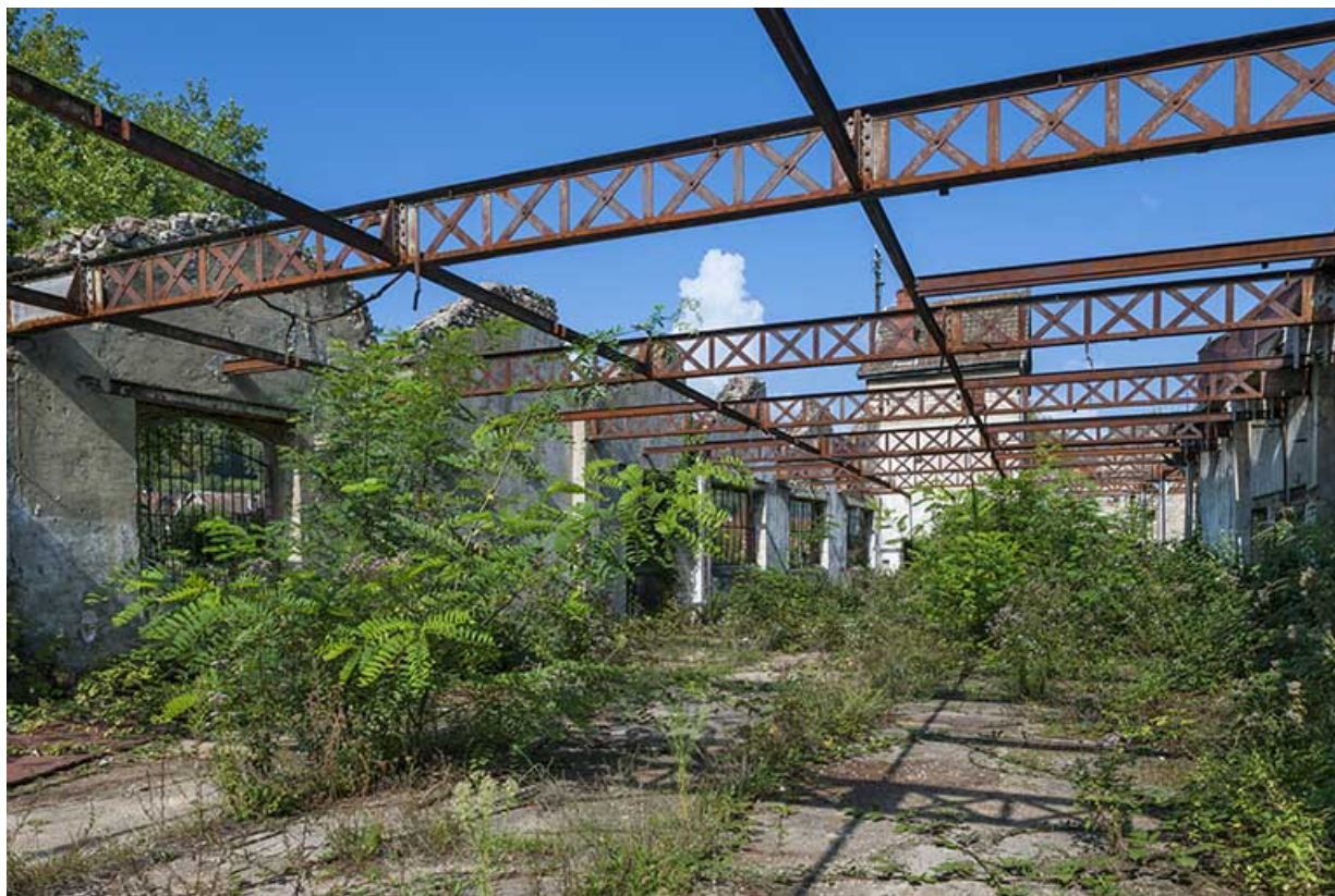
Vue Intérieure de l'atelier de fabrication.
