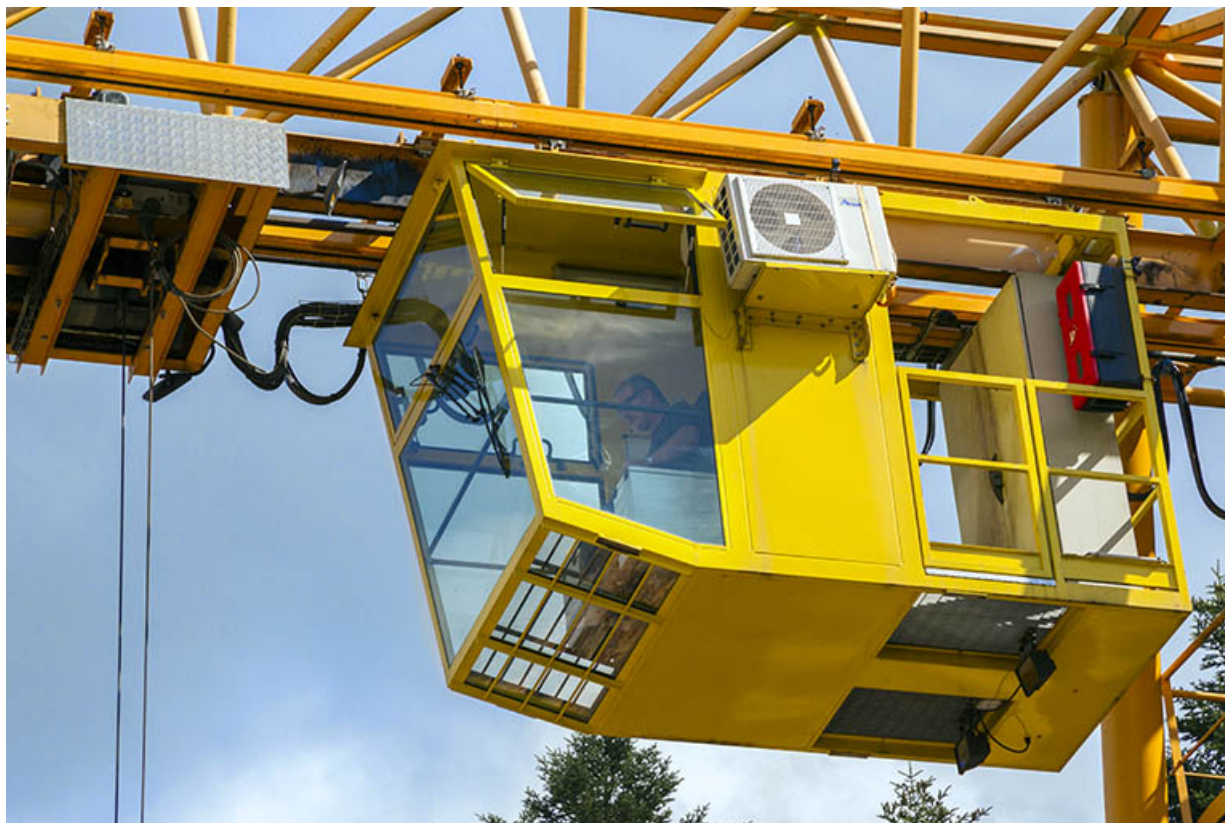
Portique roulant : cabine de commande.
