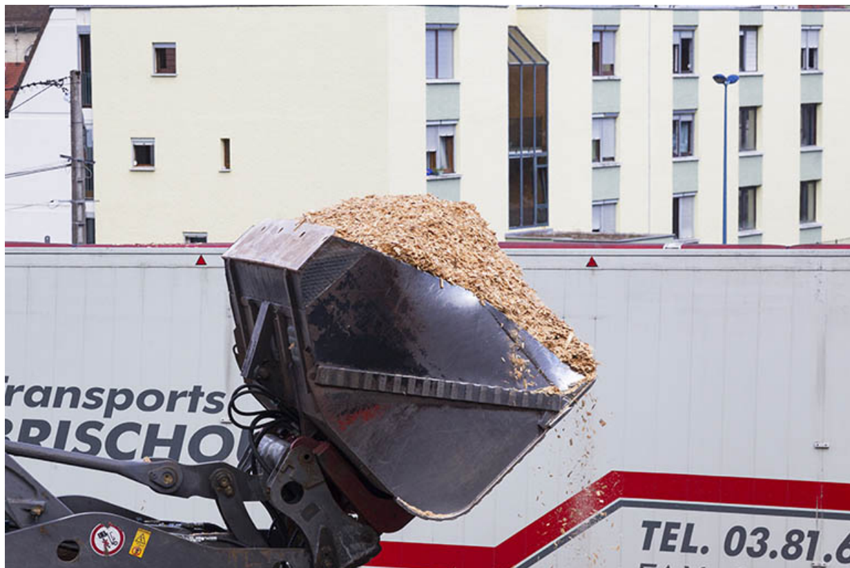
Silos à copeaux (B) : godet du chargeur. 25, Maïche rue de la Scierie
