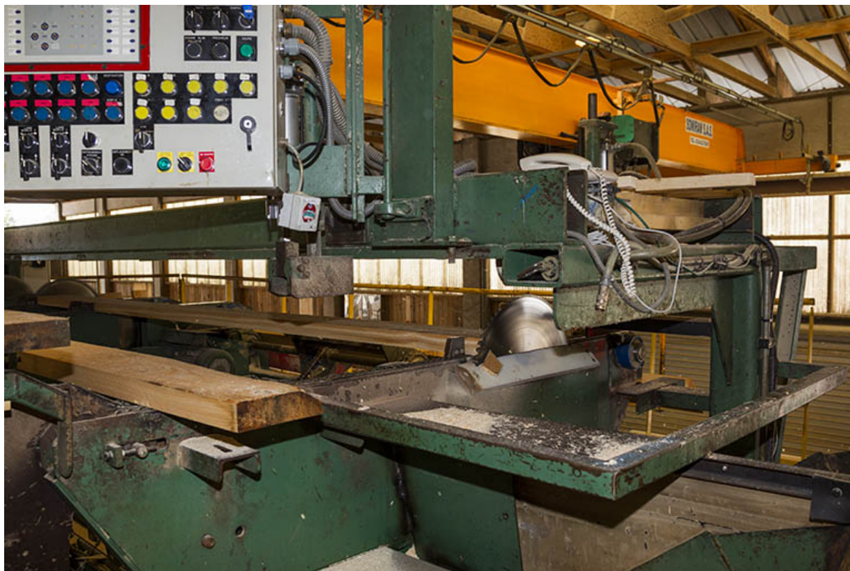
Atelier de triage et d'empilage (E) : scie circulaire de l'installation de sciage. 25, Maïche rue de la Scierie
