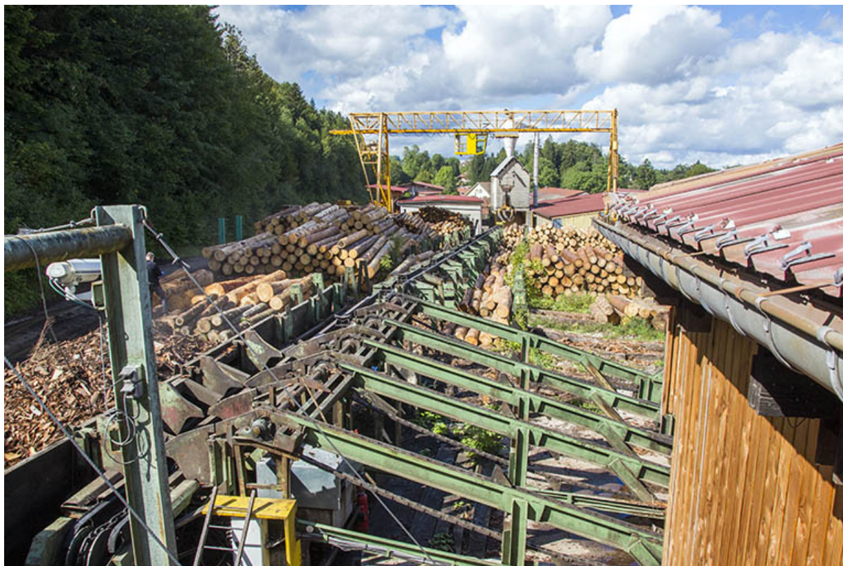
Installation de billonnage, avec le portique roulant en arrière-plan. 25, Maïche rue de la Scierie
