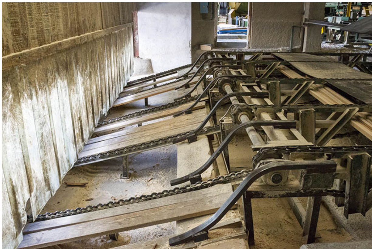
Atelier de débitage (M), extrémité nord : intérieur avec convoyeurs. 25, Maïche rue de la Scierie
