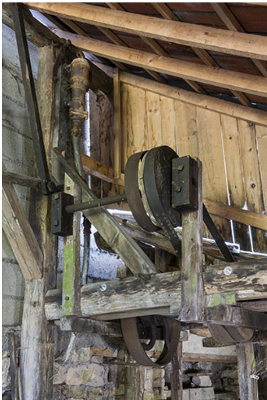
Bâtiment d'eau. Transmission supérieure au droit des turbines.
