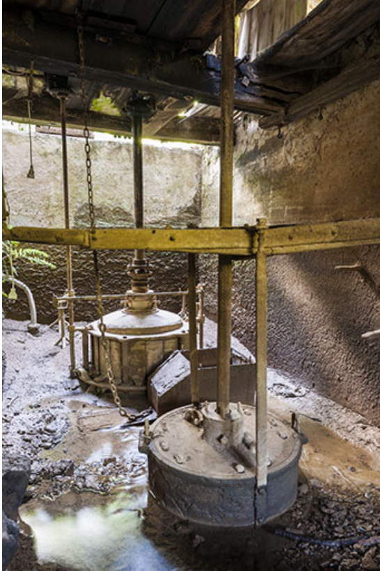
La chambre d'eau des turbines.
