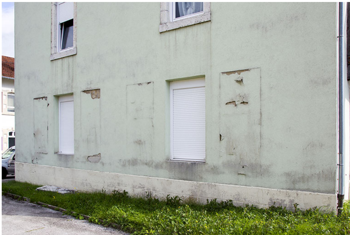
Façade latérale droite : fenêtres multiples encore visibles au rez-de-chaussée. 25, Charquemont rue de l' Eglise
