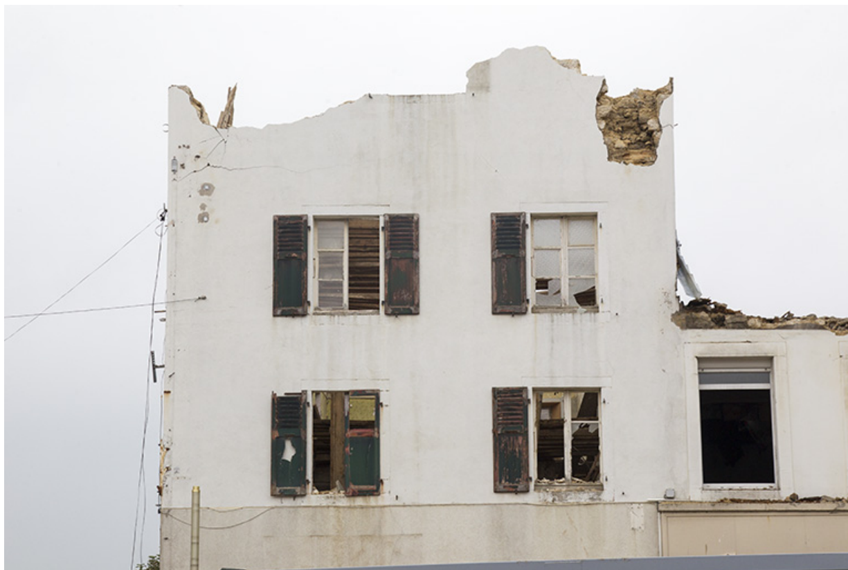
Destruction des bâtiments, 5 septembre 2012 : façade latérale droite (nord) de l'hôtel. 25, Charquemont place de l' Hôtel de Ville
