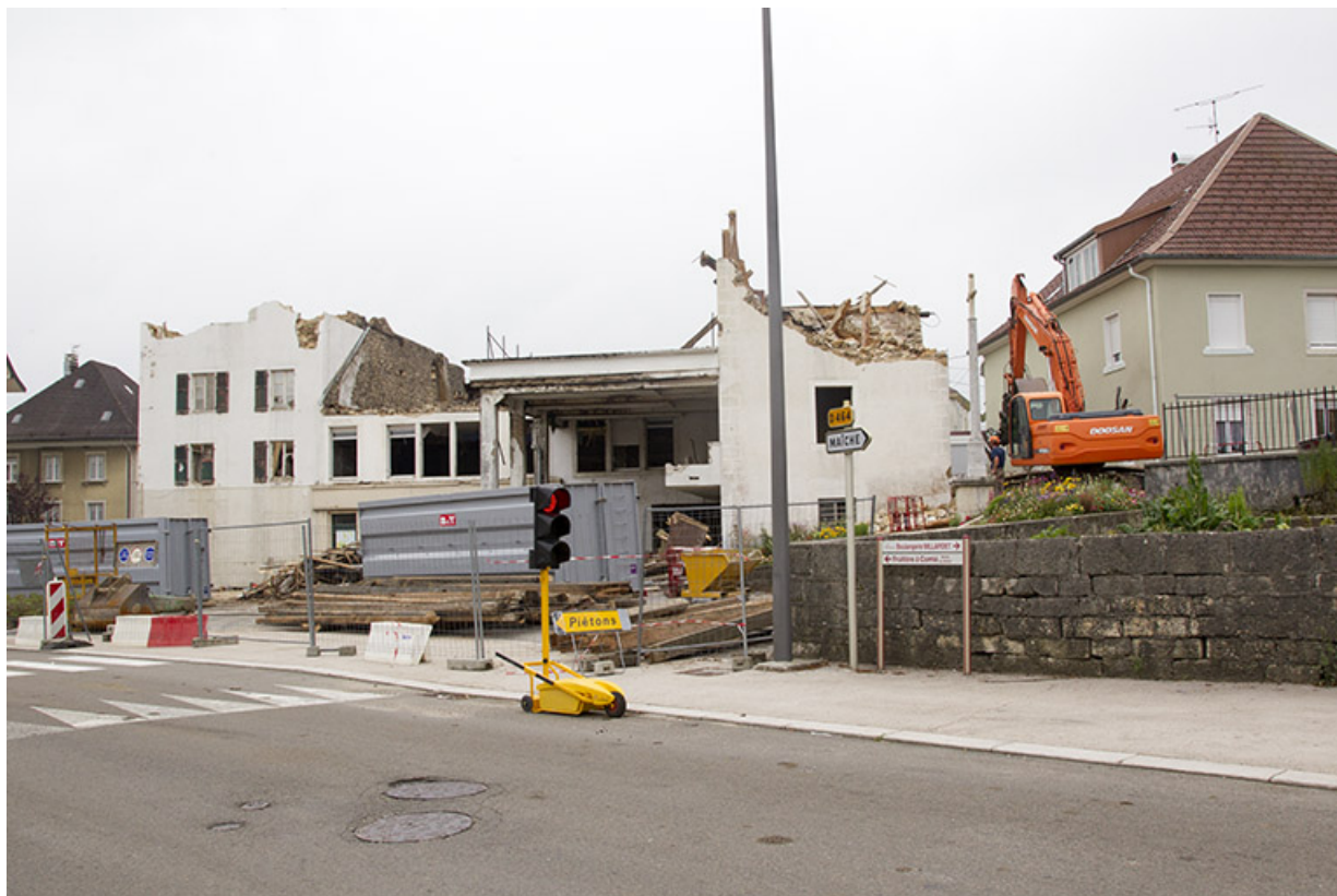
Destruction des bâtiments, 5 septembre 2012 : façades nord. 25, Charquemont place de l' Hôtel de Ville
