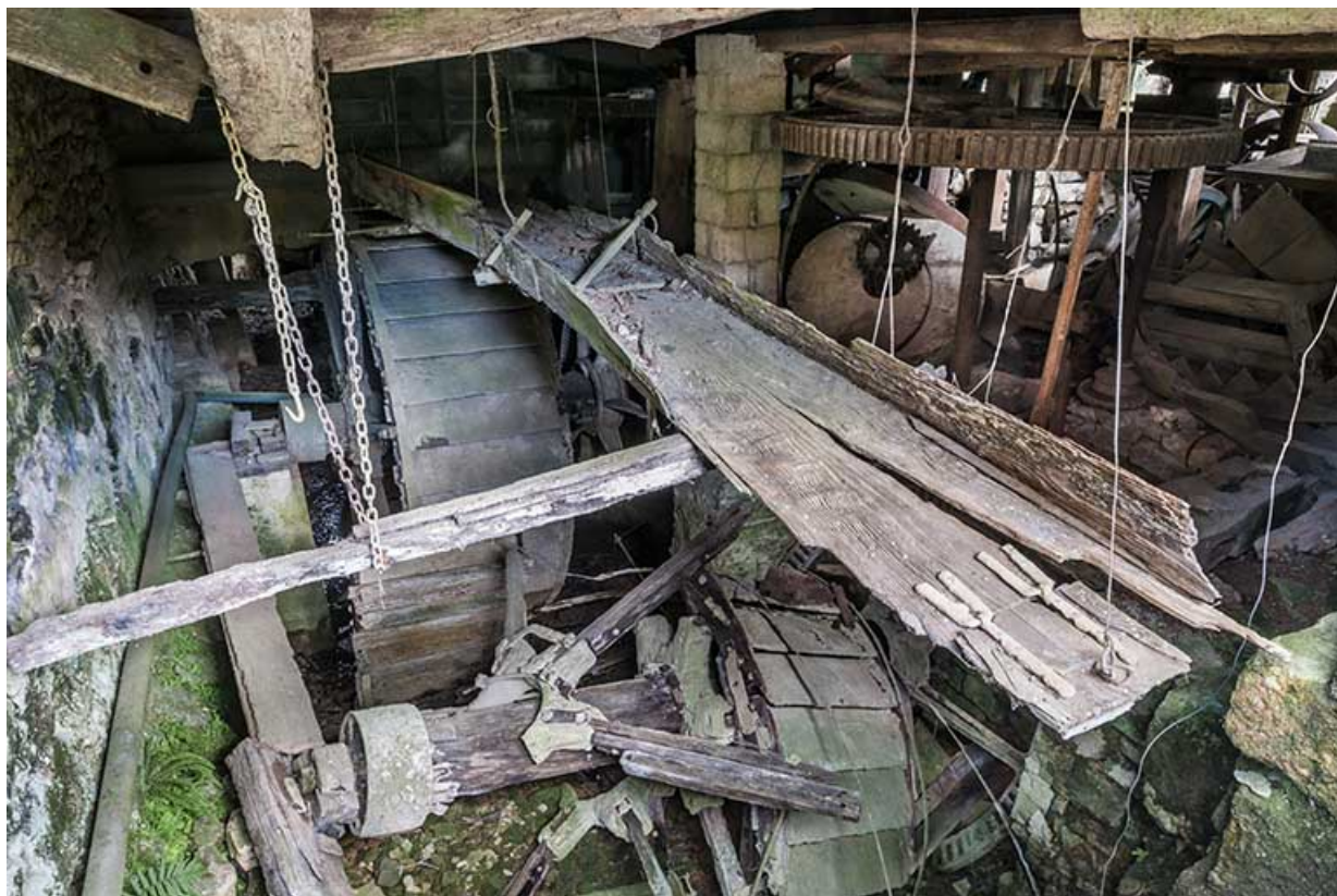
Vue plongeante sur la partie motrice : vestiges de deux roues hydrauliques et de la huche d'amenée. 25, Bremondans, lieudit : Amans
