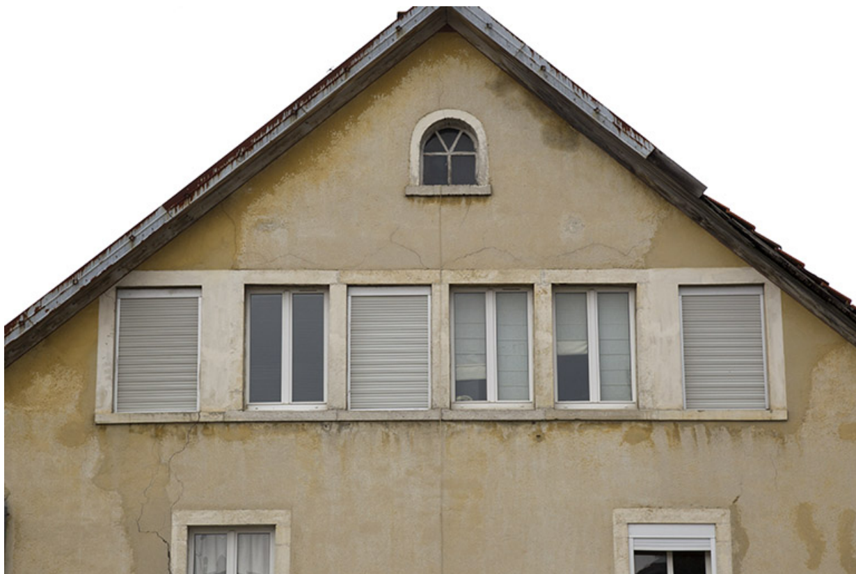
Façade postérieure en 2012 (avant rénovation) : fenêtrage multiples. 25, Charquemont, 1 rue de la Gare
