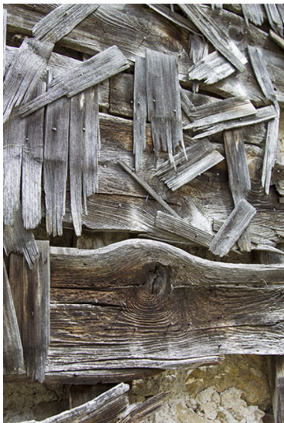
Façade postérieure : support de l'essentage de tavaillons, avec quelques tavaillons. 25, Charquemont, 48 Grande Rue
