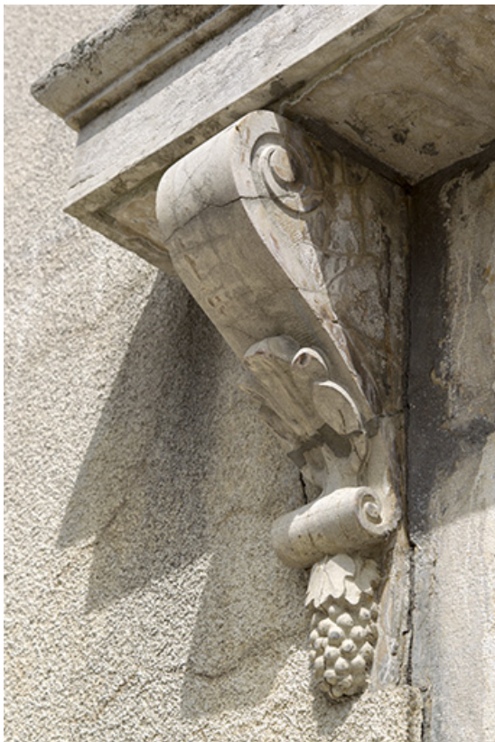
Logement patronal : console soutenant le dessus-de-fenêtre (façade antérieure). 25, Charquemont, 2 et 3 place de l' Hôtel de Ville
