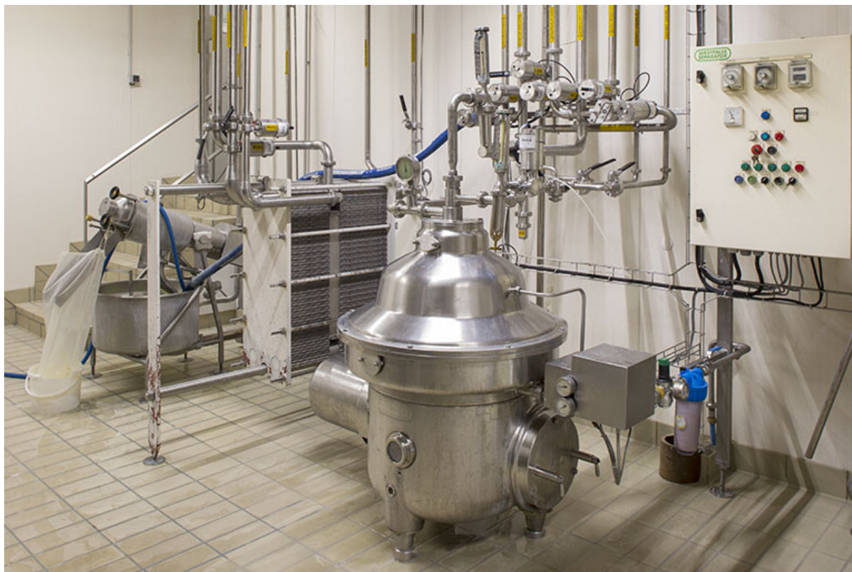
Salle de la station de lavage CIP : débourbeuse (à droite) et filtre à sérum. 25, Charquemont, 6 rue Pierre Mendès-France
