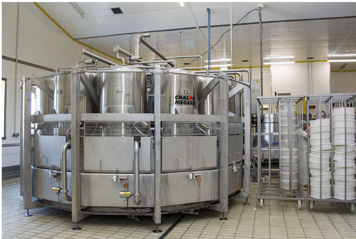
Atelier de fabrication : le soutirage sous vide. 25, Charquemont, 6 rue Pierre Mendès-France
