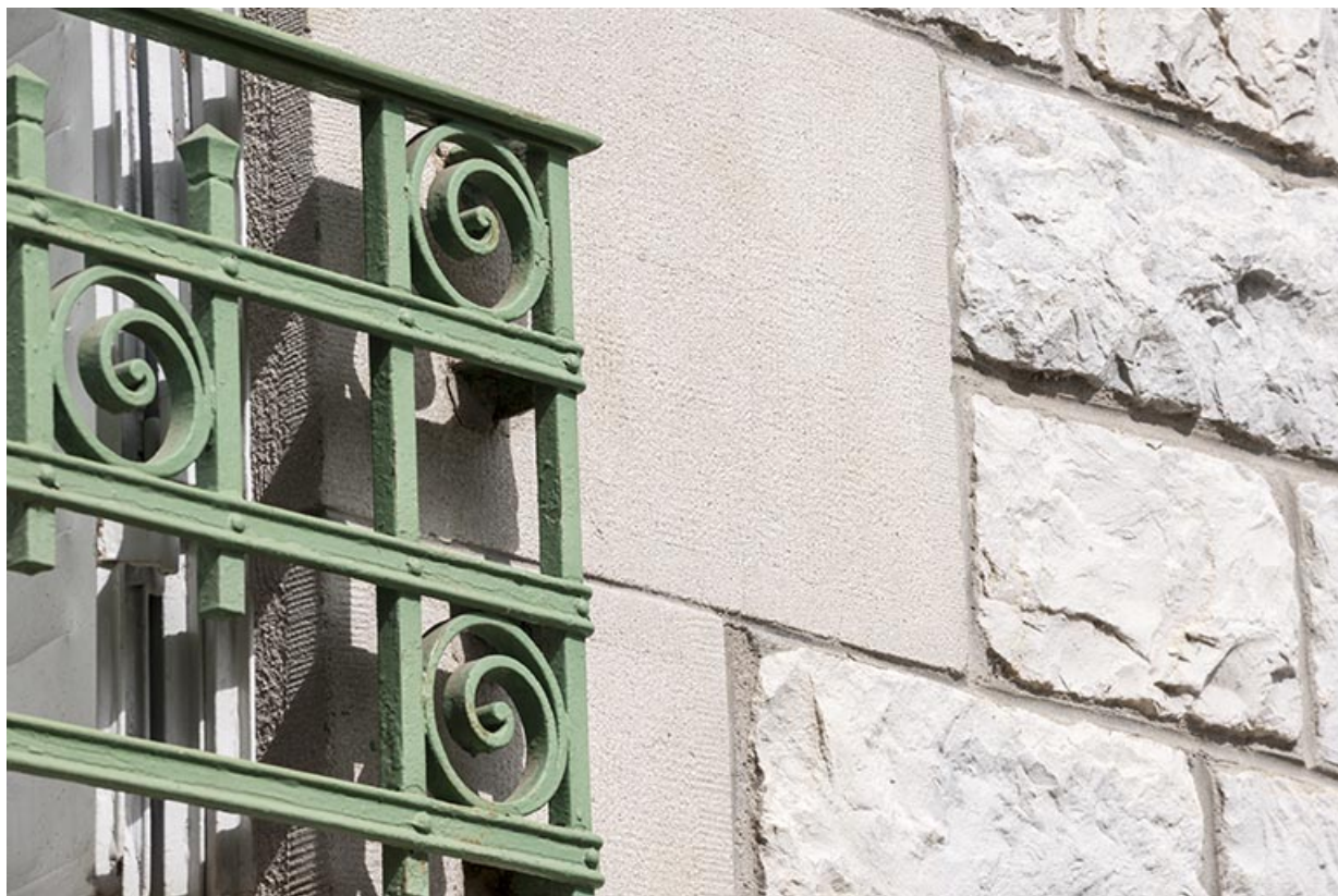
Façade latérale gauche : détail de l'appareillage du mur, de l'encadrement de fenêtre en béton et de la ferronnerie. 25, Besançon, 1 bis rue Victor Delavelle
