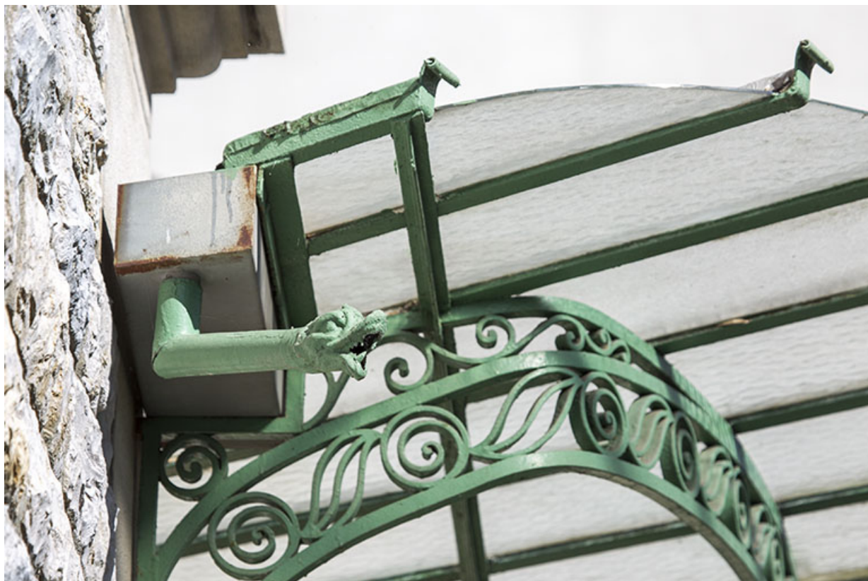
Façade antérieure : ferronnerie et gargouille de la marquise (côté gauche). 25, Besançon, 1 bis rue Victor Delavelle
