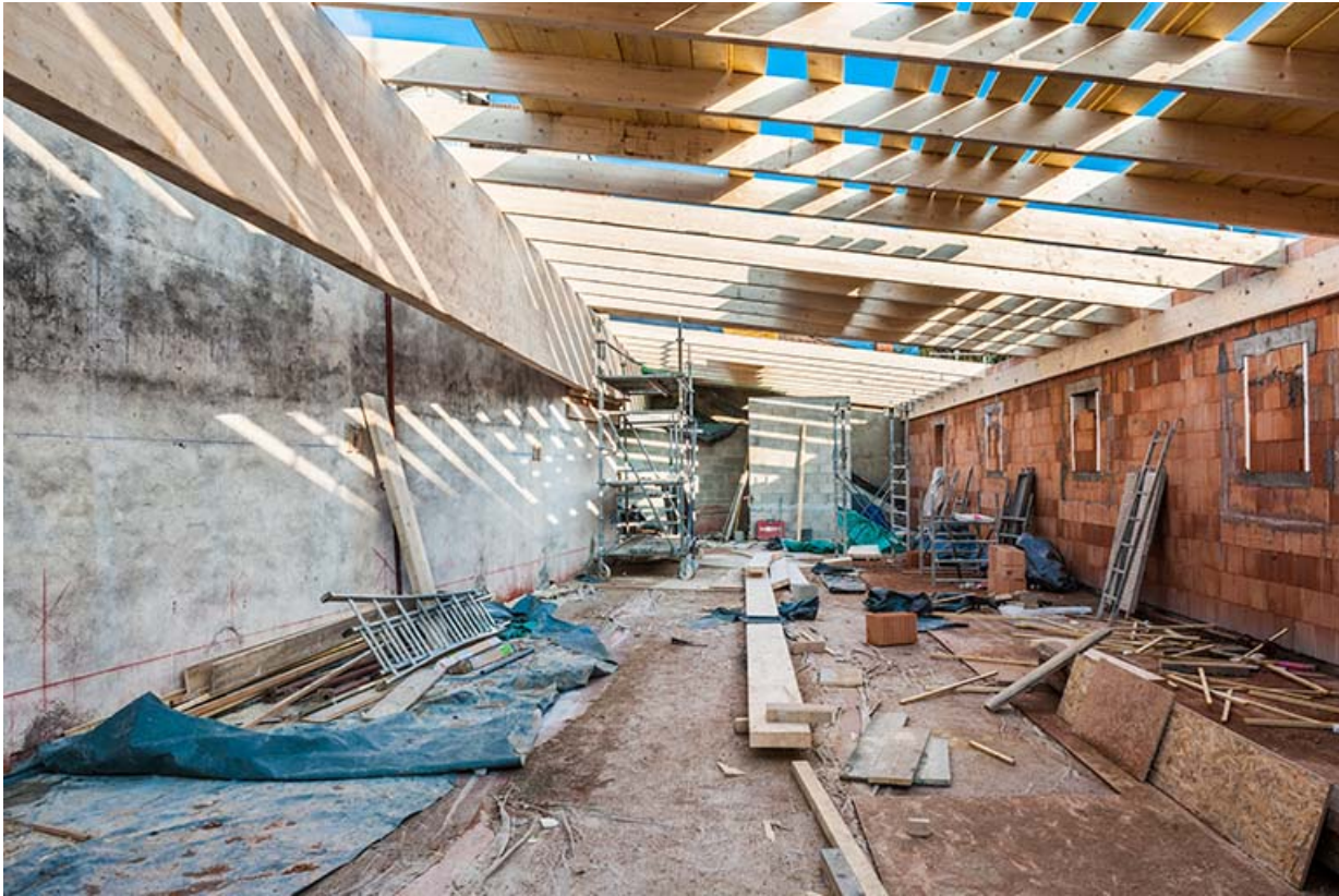
L'entrepôt en cours de surélévation en 2003 : intérieur de l'étage en surcroît depuis le fond. 25, Besançon, 1 ter et 3 rue Victor Delavelle
