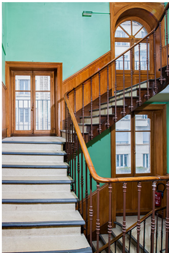
Bâtiment de l'administration, cage d'escalier : volées du 1er au 2e étage. 25, Besançon, 1 ter et 3 rue Victor Delavelle
