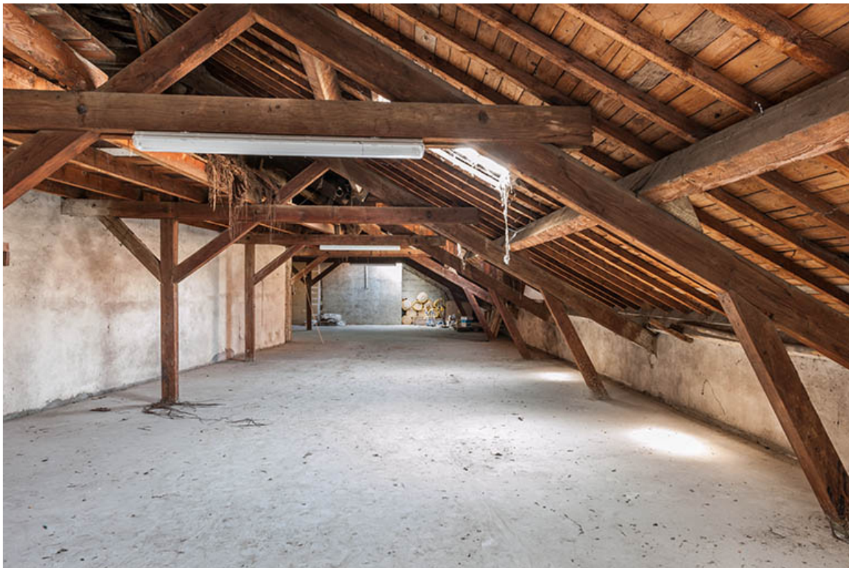
L'entrepôt avant sa surélévation en 2003 : la charpente depuis le fond de l'étage en surcroît.
