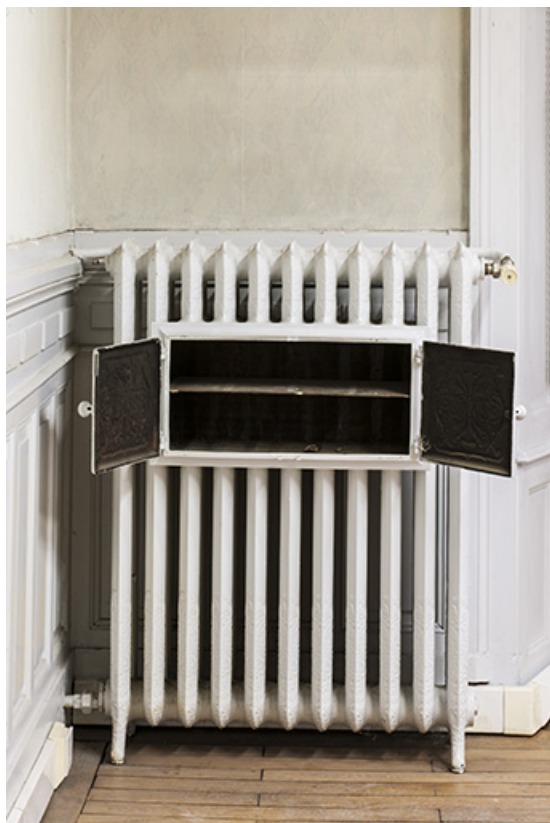
Bâtiment de l'administration, 1er étage : radiateur à chauffe-plat, avec chauffe-plat ouvert. 25, Besançon, 1 ter et 3 rue Victor Delavelle
