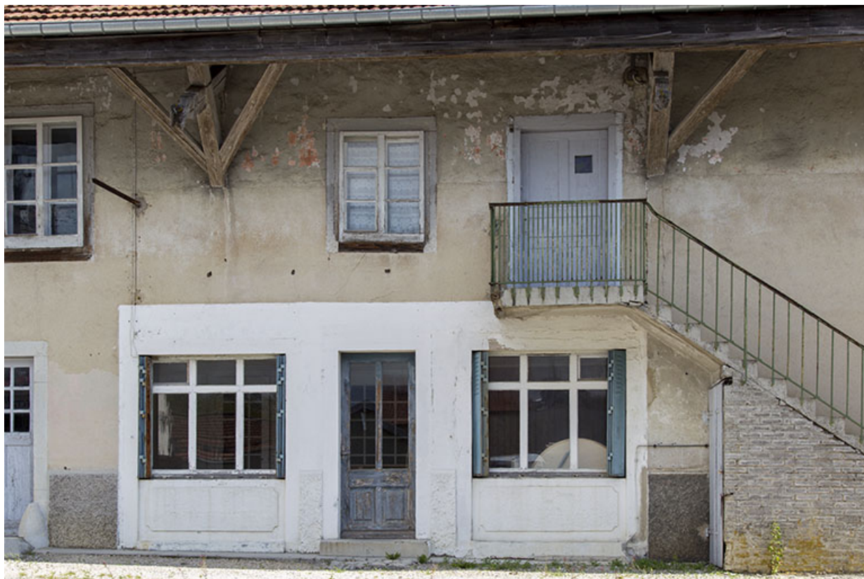
Façade latérale gauche : entrées au rez-de-chaussée et à l'étage. 25, Charquemont, 9 Grande Rue
