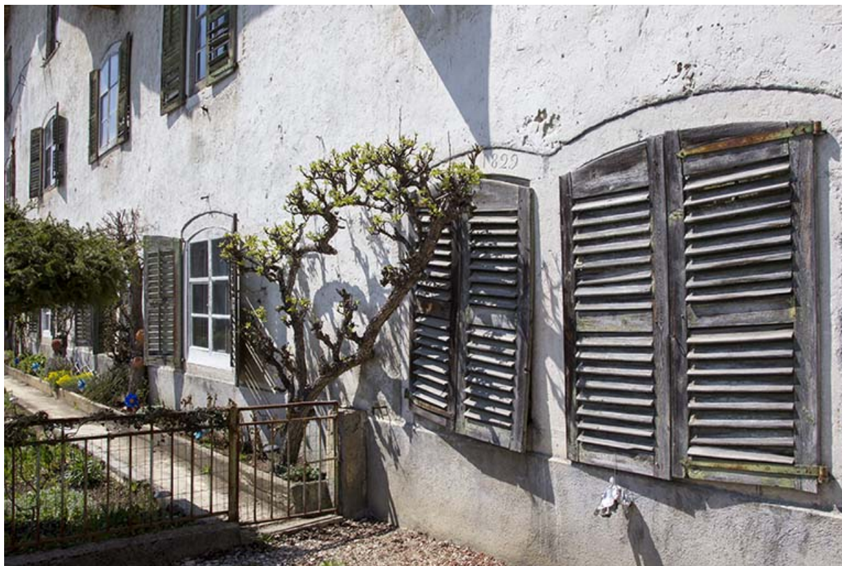
Façade antérieure : fenêtres horlogères à linteau délardé en arc segmentaire. 25, Charquemont, 9 Grande Rue
