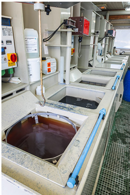
Usine : atelier de galvanoplastie (installations de l'îlot central depuis l'angle est). 25, Frambouhans, 4 rue de la Velle
