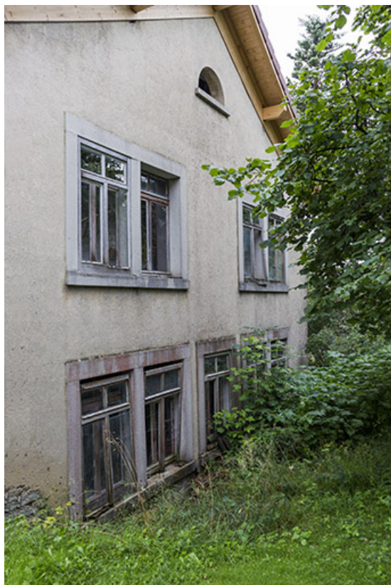
Usine : façade postérieure, de trois quarts gauche. 25, Frambouhans, 2 rue de la Bonneterie
