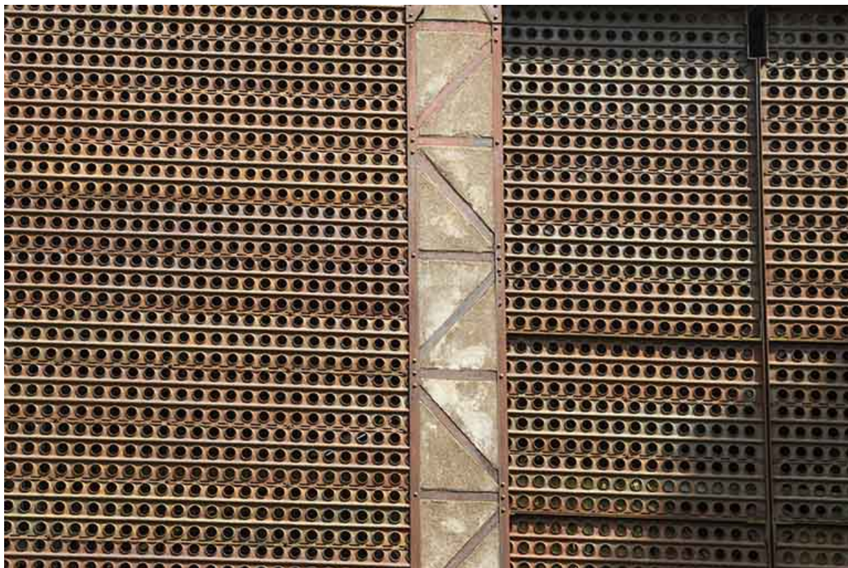
Site rue du Jura : paroi de l'entrepôt industriel (plaques de désensablement). 25, Tréviillers, 11 rue du Jura
