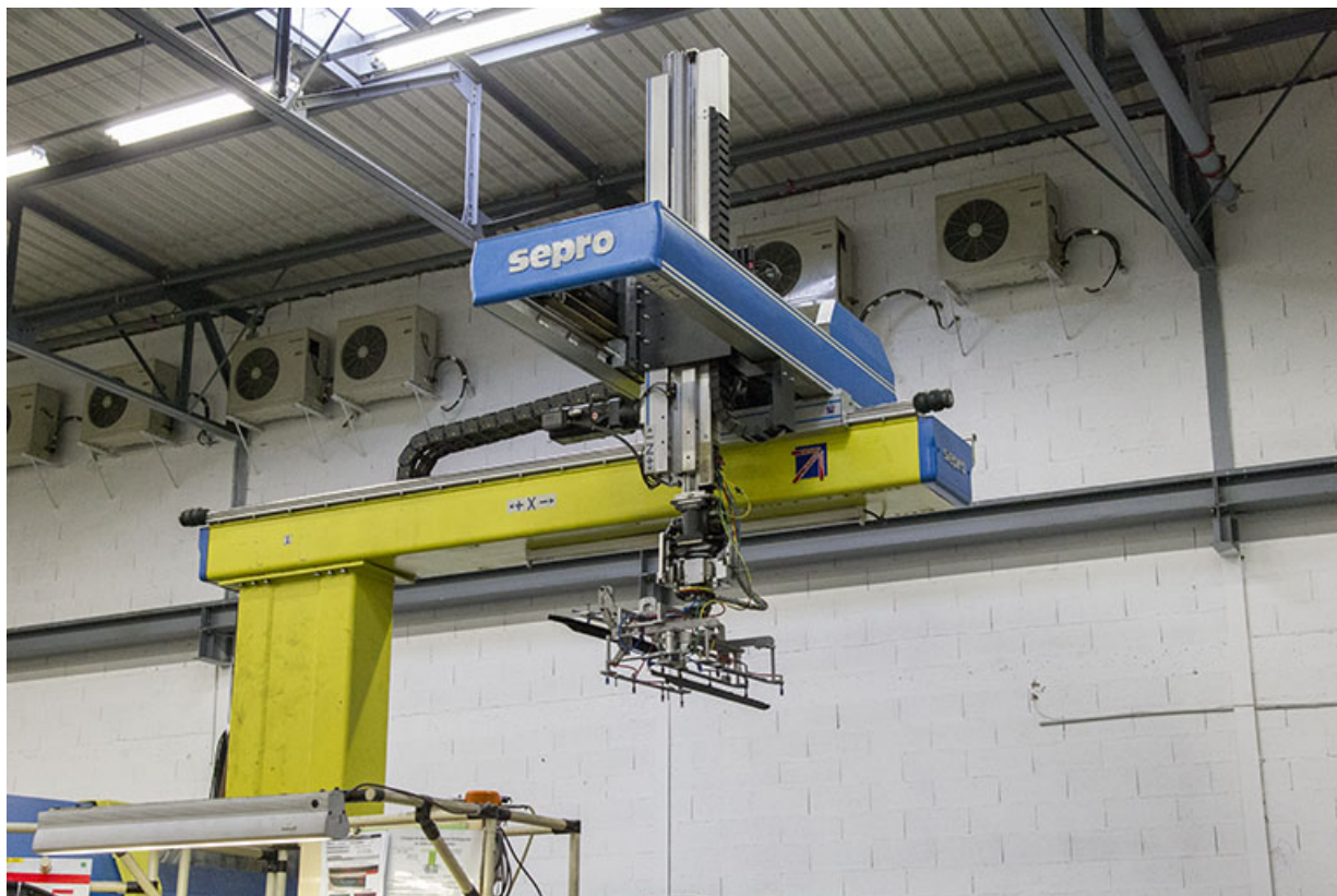
Site récent : robot de déchargement d'une presse à injecter. 25, Morteau, 13 rue du Maréchal Leclerc
