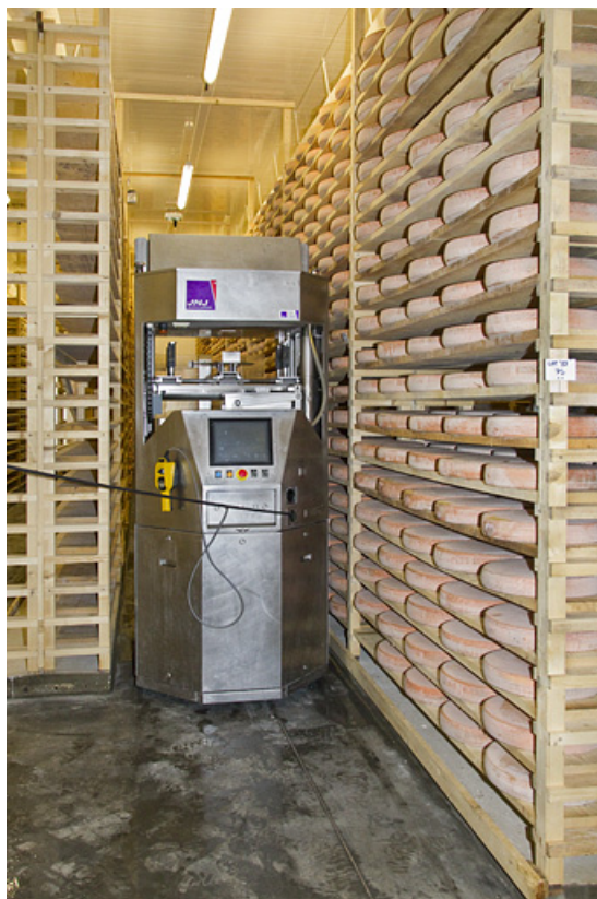
Fabrication du morbier : robot de soins (salage et retournement des meules) JNJ Automation. 25, Damprichard, 20 rue des Ecoles
