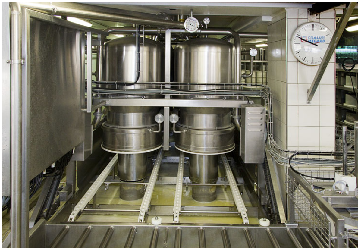
Fabrication du comté : installation de soutirage (face avant).
