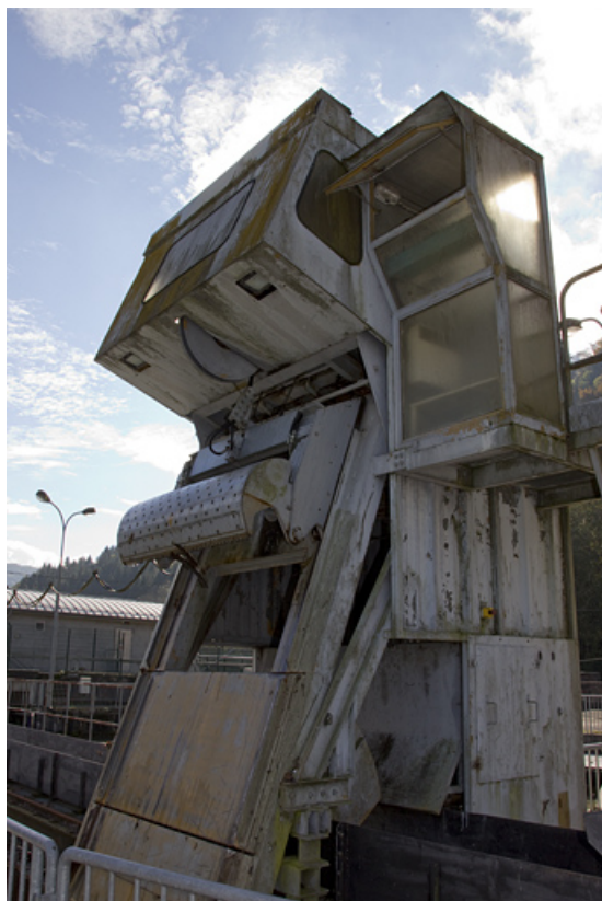
Prise d'eau : le dégrilleur, de trois quarts droite.
