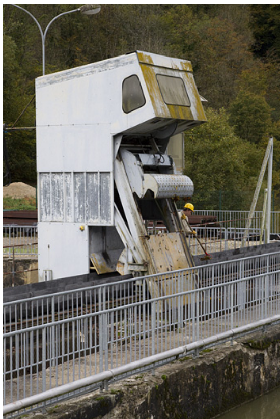
Prise d'eau : le dégrilleur, de trois quarts gauche.
