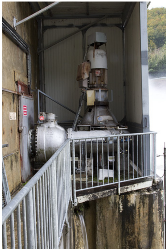
Centrale : ancien groupe de restitution.
