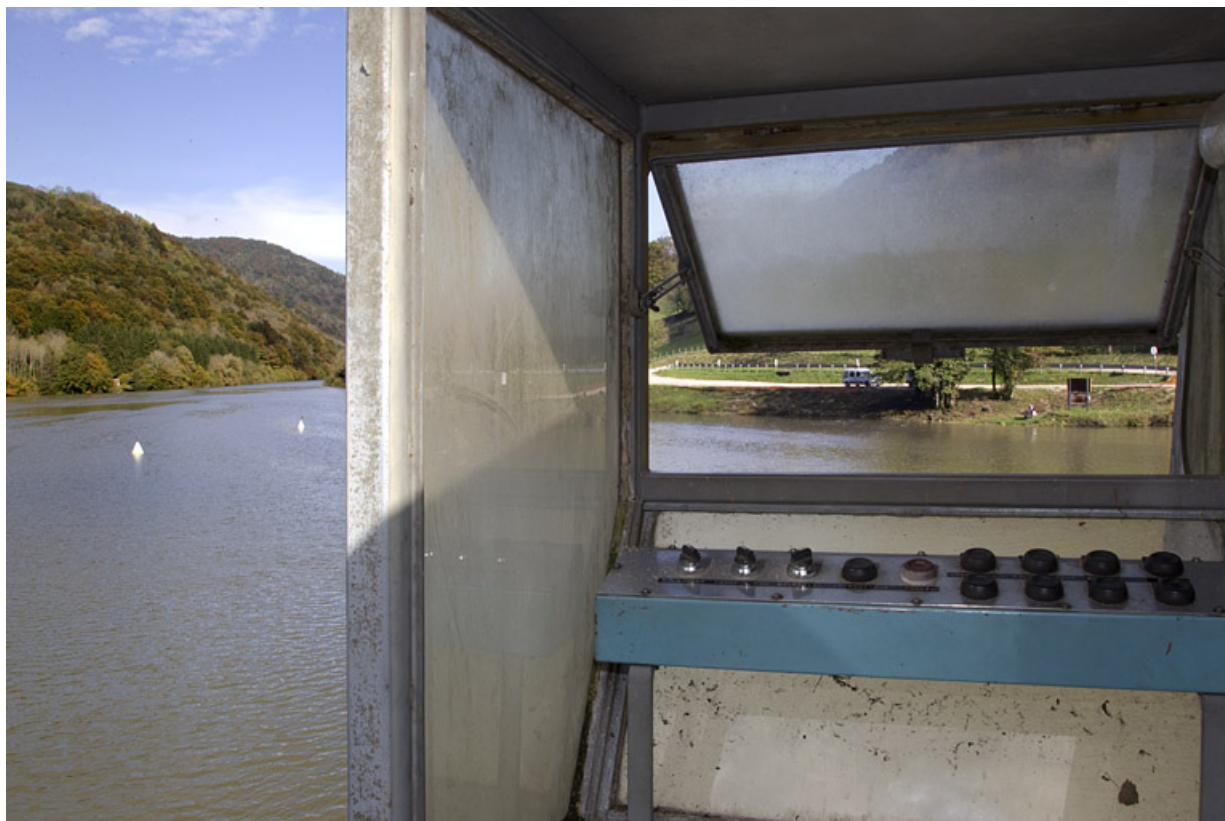
Prise d'eau : poste de commande du dégrilleur.
