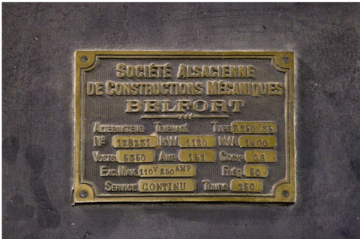
Centrale : plaque signalétique de l'alternateur.
