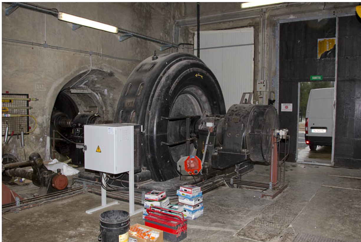
Centrale : intérieur de la salle des machines et groupe de hautes eaux. 25, Soulce-Cernay, lieudit : Gros Bois
