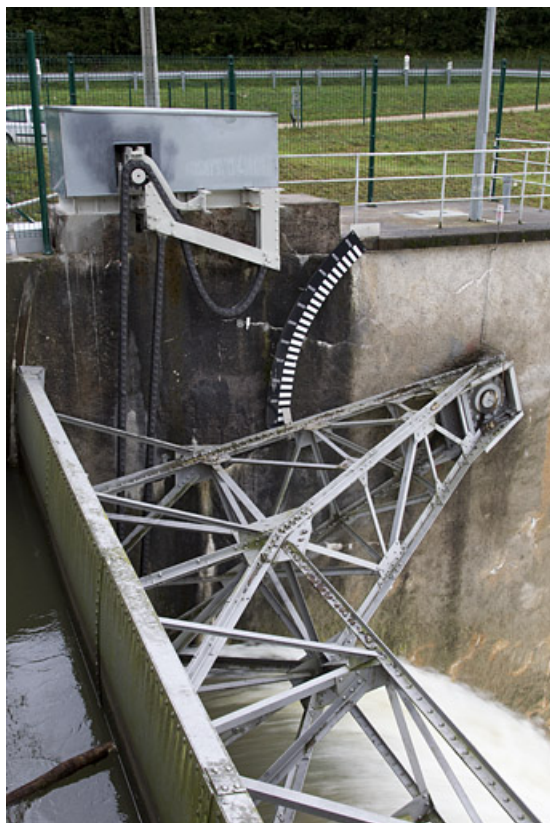
Barrage : système d'ouverture d'une vanne secteur (vanne évacuateur de crue). 25, Soulce-Cernay, lieudit : Gros Bois
