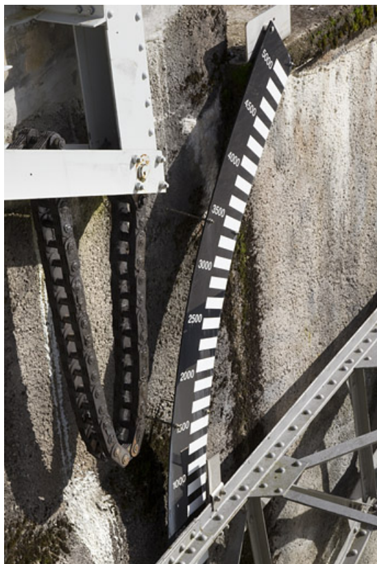
Barrage : repère mesurant l'ouverture d'une vanne secteur.
