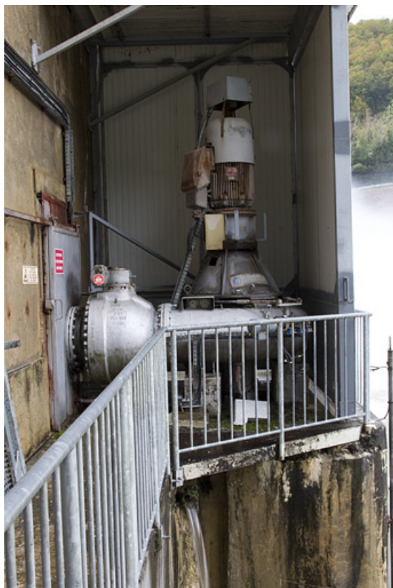
Centrale : ancien groupe de restitution.
