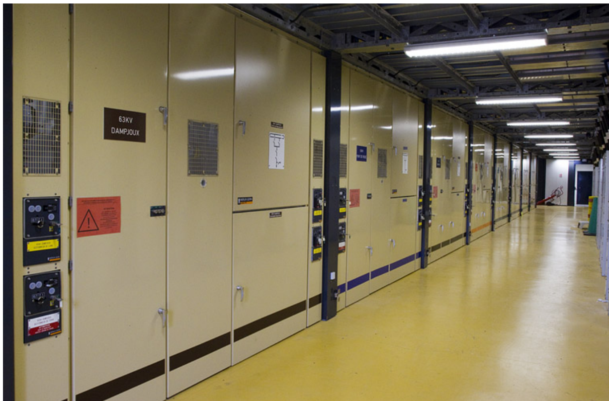
Transformateur RTE : intérieur. 25, Liebvillers, lieudit : Moulin Artus
