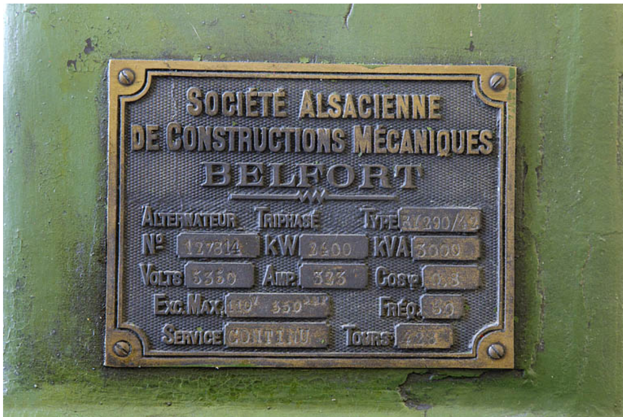
Centrale : plaque signalétique de l'alternateur du groupe n° 1 25, Liebvillers, lieudit : Moulin Artus
