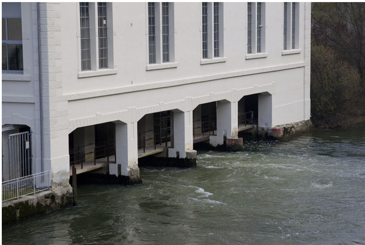
Centrale : étage de soubassement et sortie des chambres d'eau.
