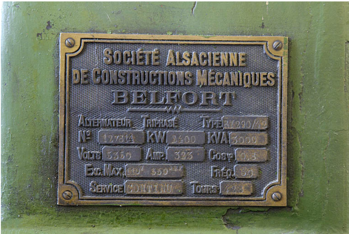
Centrale : plaque signalétique de l'alternateur du groupe n° 1 25, Liebvillers, lieudit : Moulin Artus
