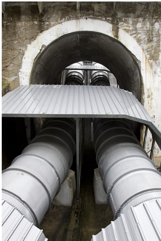
Conduites forcées à la sortie du pont sous la route départementale. 25, Liebvillers, lieudit : Moulin Artus
