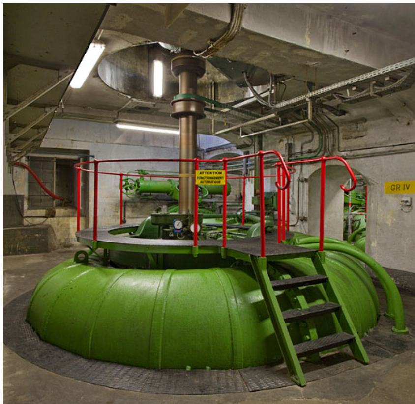
CenTrale : bâche de la turbine du groupe n° 4 et axe de transmission, à l'étage de soubassement.
