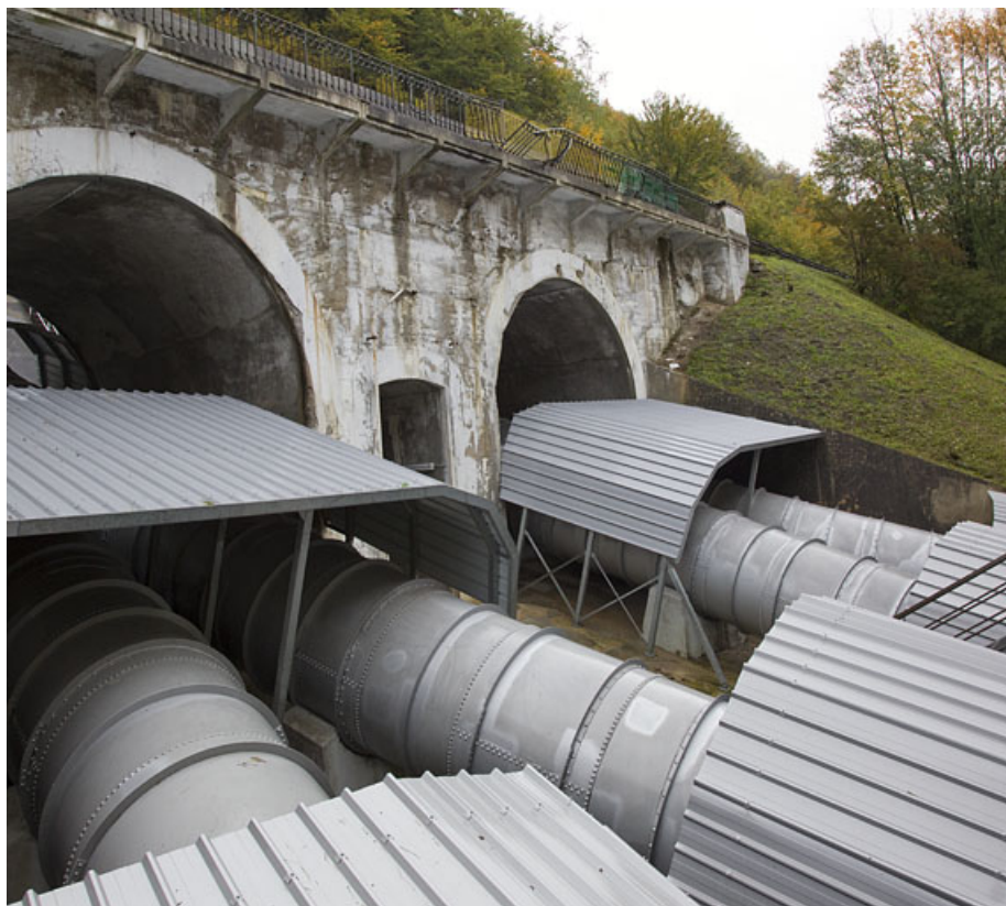
Conduites forcées à la sortie du pont de la route départementale, vues de trois quarts. 25, Liebvillers, lieudit : Moulin Artus
