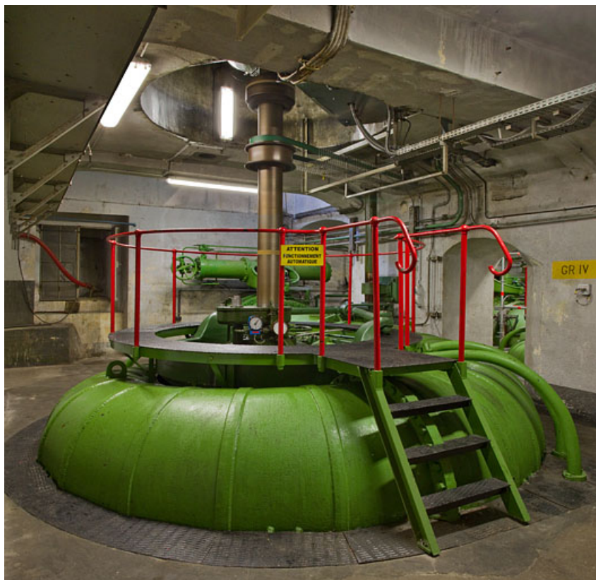
CenTrale : bache de la turbine du groupe n° 4 et axe de transmission, à l'étage de soubassement.
