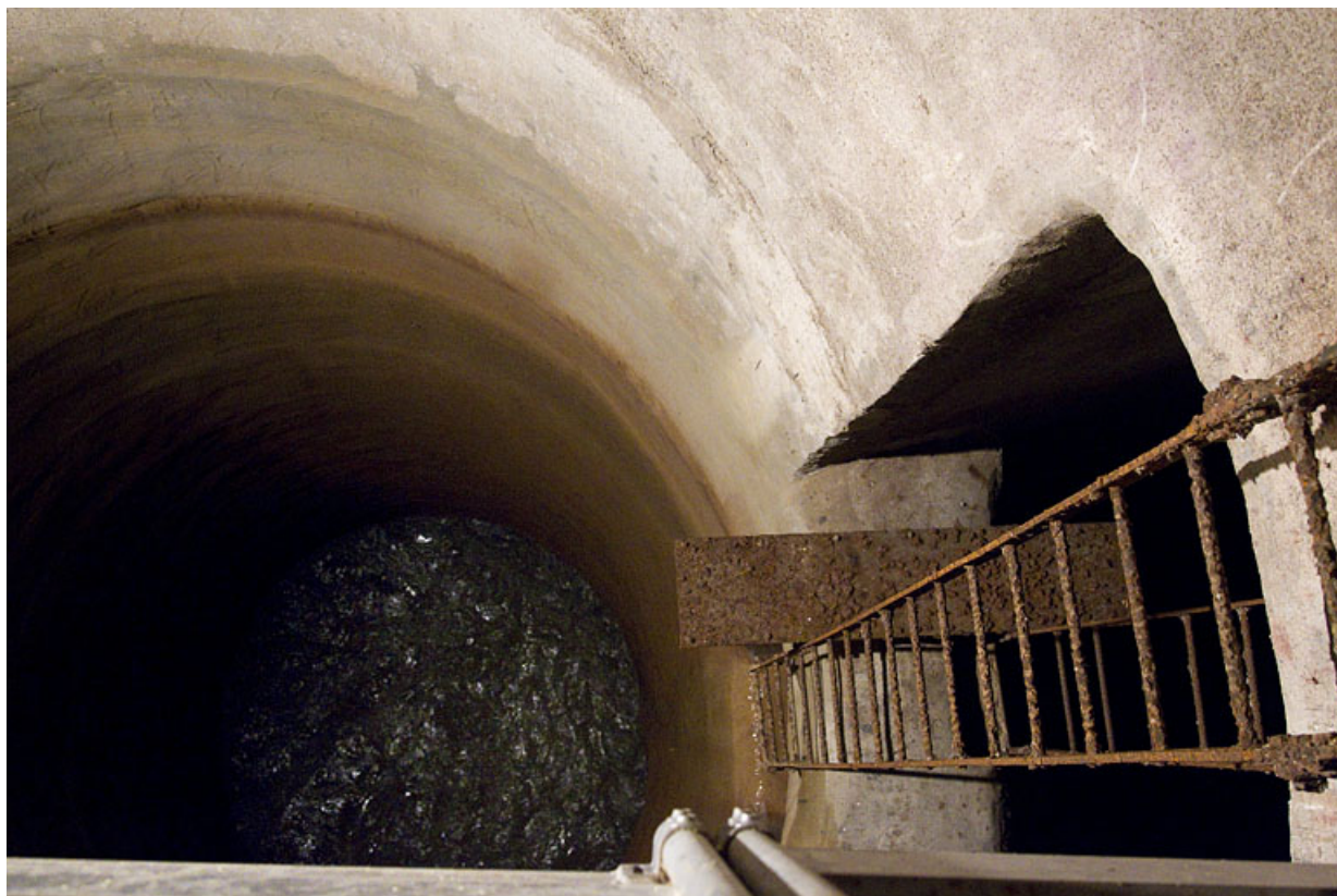
Tunnel d'amenée d'eau : cheminée d'équilibre.
