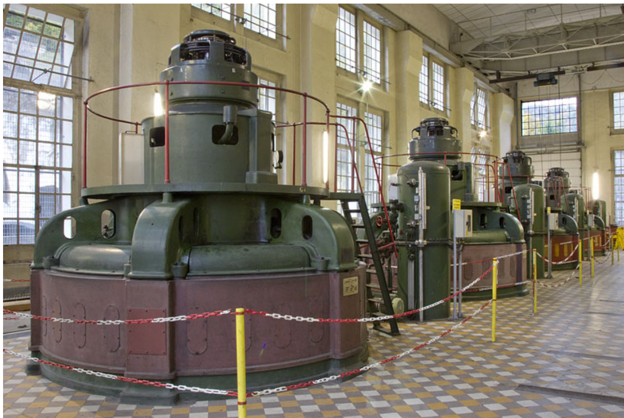
Centrale : vue d'ensemble des groupes (n° 4 à 1). 25, Liebvillers, lieudit : Moulin Artus
