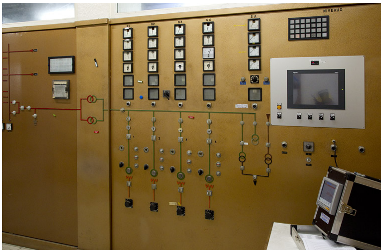
Centrale : détail des tableaux du poste de commande.
