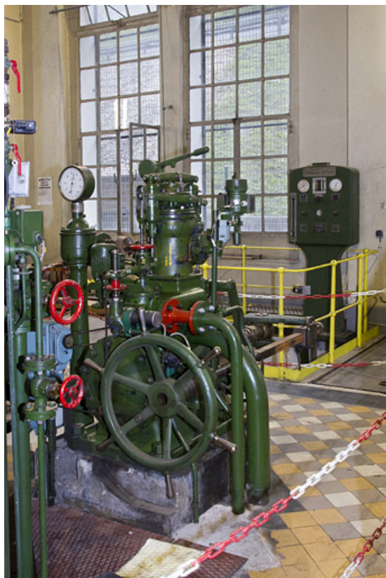
Centrale : régulateur de vitesse du groupe n° 4. 25, Liebvillers, lieudit : Moulin Artus
