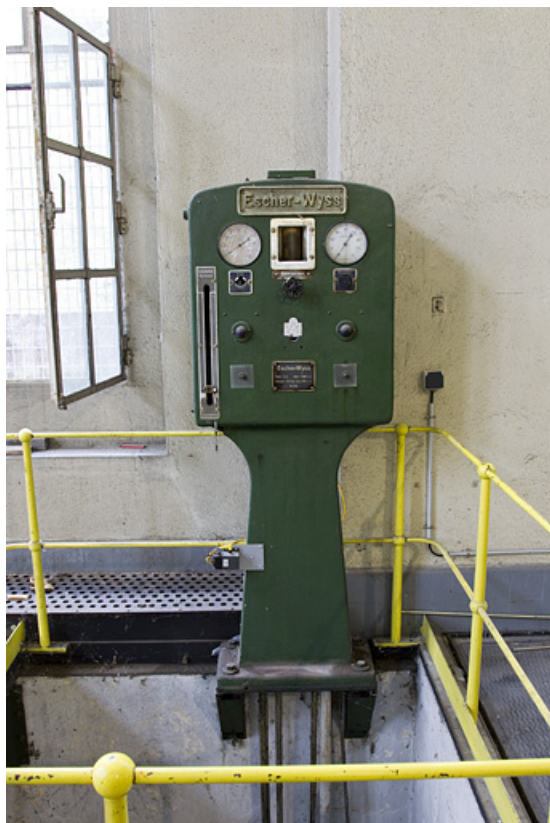
Centrale : commande de la vanne de pied du groupe n° 4. 25, Liebvillers, lieudit : Moulin Artus
