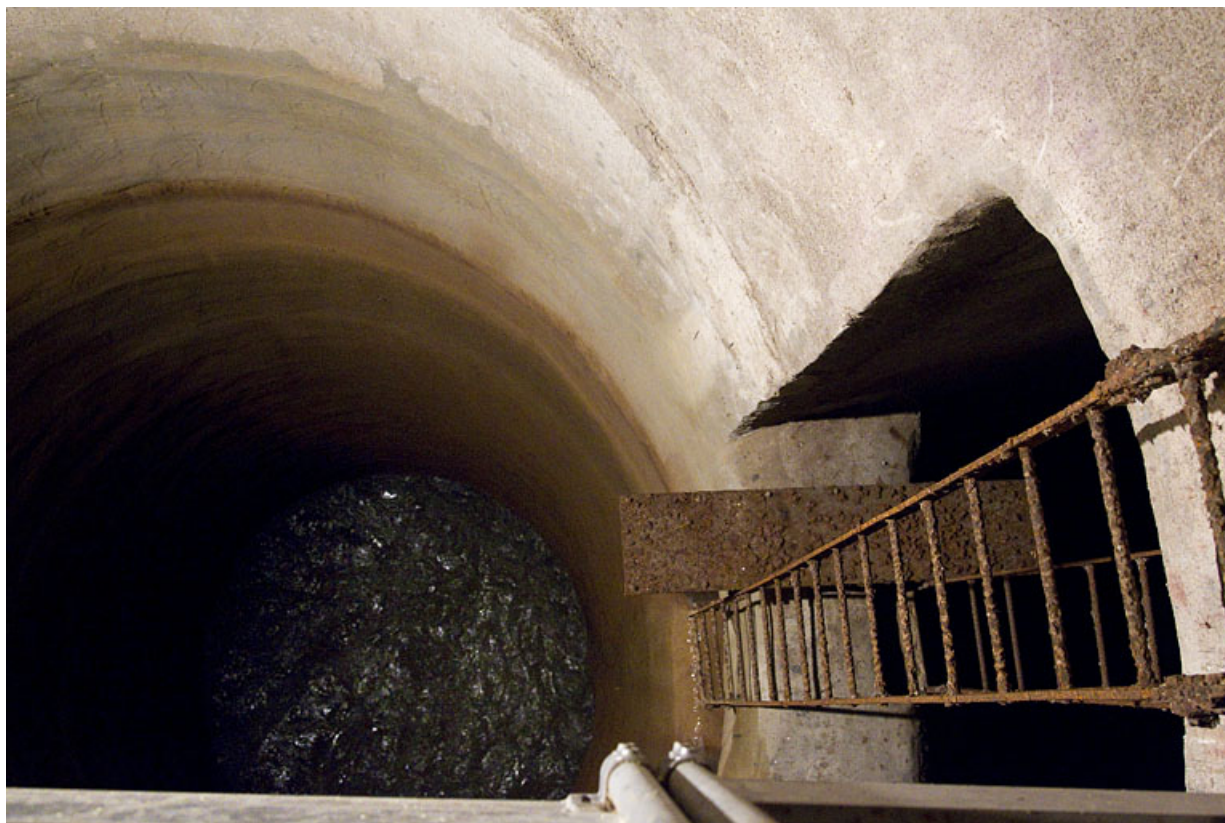
Tunnel d'amenée d'eau : cheminée d'équilibre.
