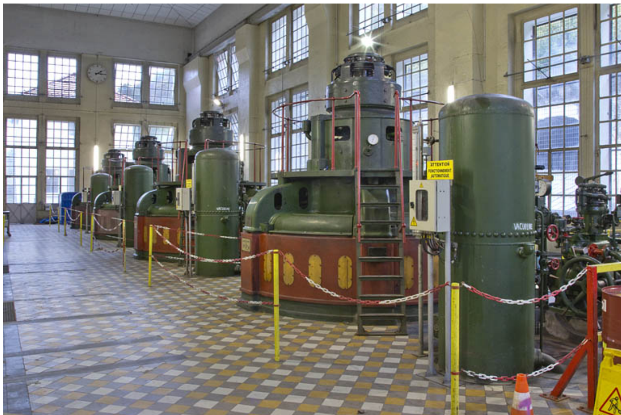
Centrale : vue d'ensemble des groupes (n° 1 à 4). 25, Liebvillers, lieudit : Moulin Artus
