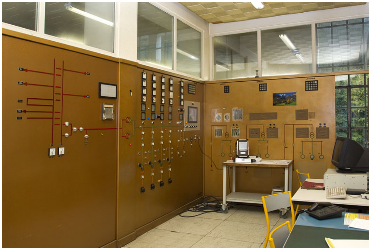
Centrale : poste de commande des centrales de Liebvillers, Dampjoux, Vaufrey et le Refrain. 25, Liebvillers, lieudit : Moulin Artus
