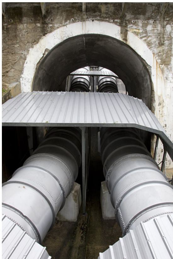
Conduites forcées à la sortie du pont sous la route départementale.
