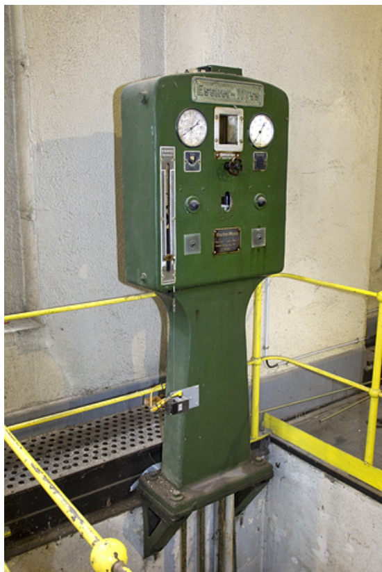
Centrale : commande de la vanne de pied du groupe n° 4., de trois quarts 25, Liebvillers, lieudit : Moulin Artus
