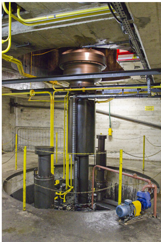
Groupe n° 1 : axe de la turbine (cadrage vertical).
