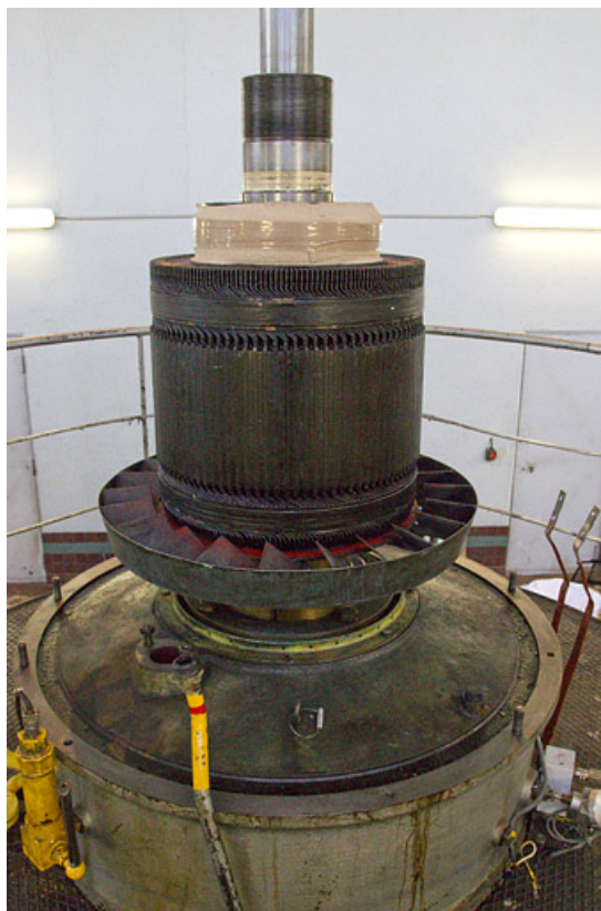
Groupe n° 2 : excitatrice partiellement démontée. 25, Vaufrey, lieu dit : Barrage de Vaufrey
