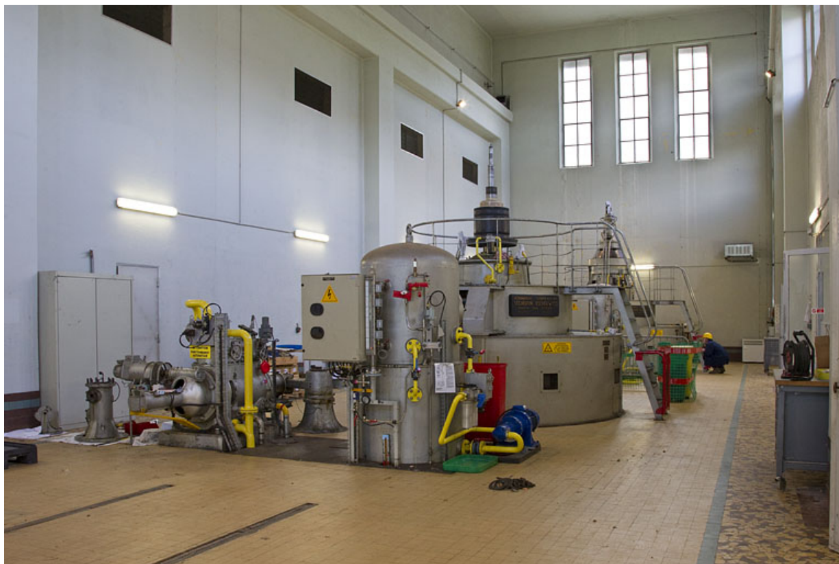
Intérieur de la salle des machines.
