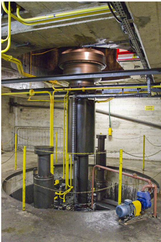
Groupe n° 1 : axe de la turbine (cadrage vertical). 25, Vaufrey, lieu dit : Barrage de Vaufrey
