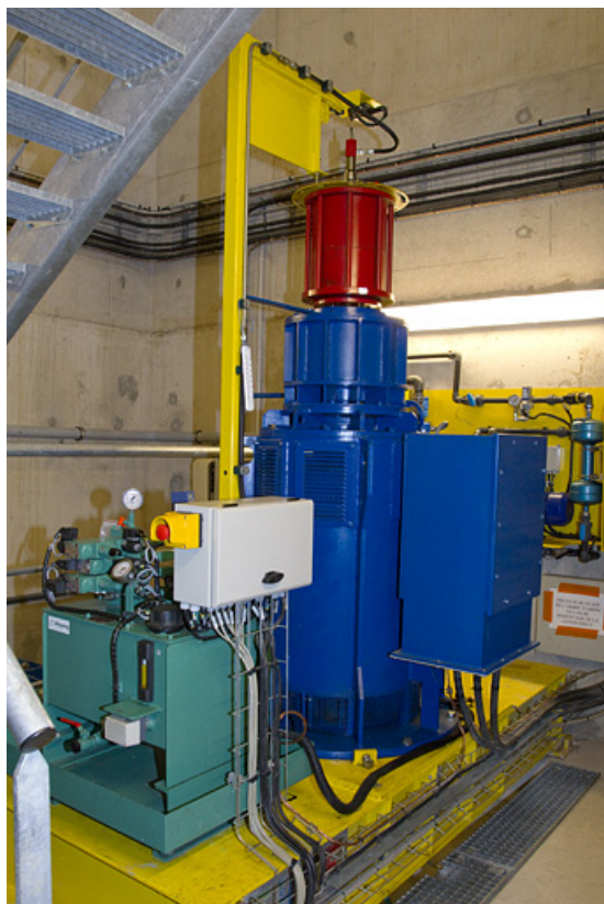
Barrage : le groupe de restitution (MarelliMotori). 25, Fournet-Blancheroche, lieudit : Barrage du Refrain
