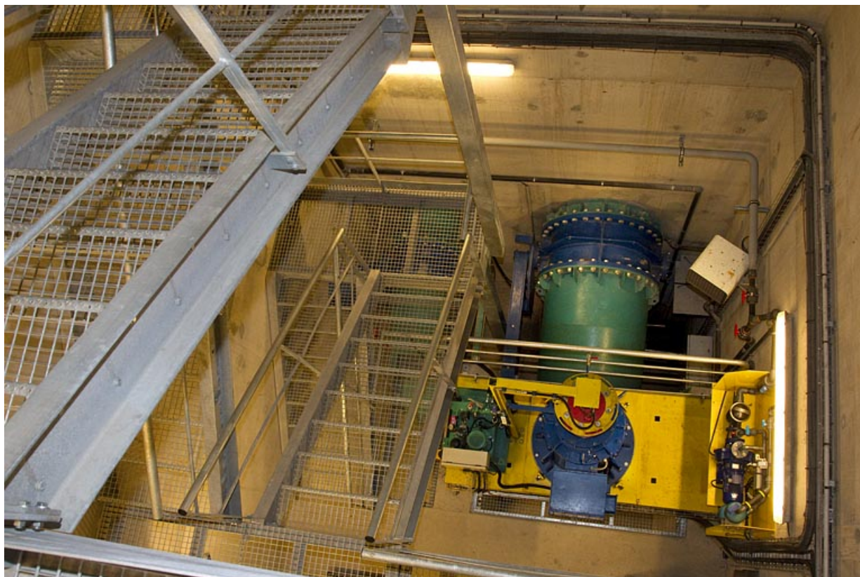
Barrage : intérieur de la centrale du groupe de restitution.
