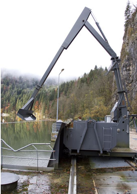
Prise d'eau : dégrilleur automatique (utilisé pour le nettoyage des grilles de protection). 25, Fournet-Blancheroche, lieudit : Barrage du Refrain
