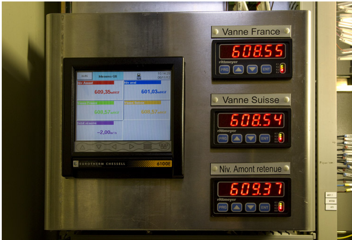
Barrage : cadran numérique de contrôle du fonctionnement des vannes et du niveau de la retenue. 25, Fournet-Blancheroche, lieudit : Barrage du Refrain
