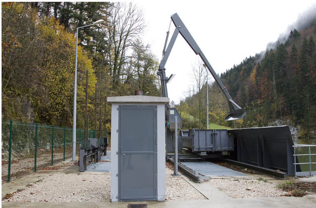
Prise d'eau : dégrilleur automatique et édicule protégeant un puits limnimétrique.
