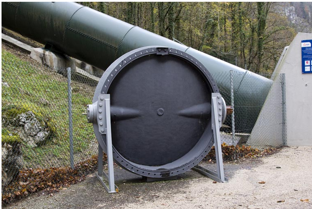
Vanne papillon présentée près de la conduite forcée.
