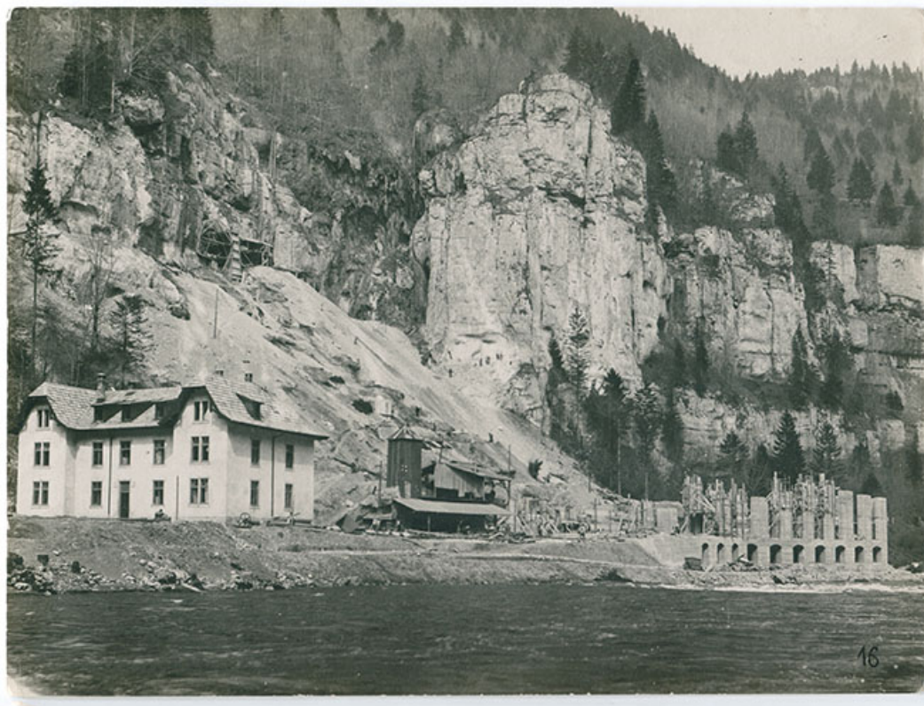
[Vue d'ensemble du site, avec construction des murs de la centrale], [1908 ?]. 25, Charquemont, lieudit : Mortier
