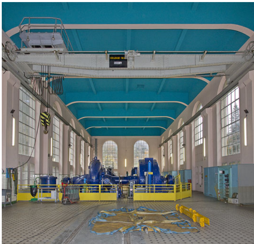
Centrale : intérieur de la salle des machines.
