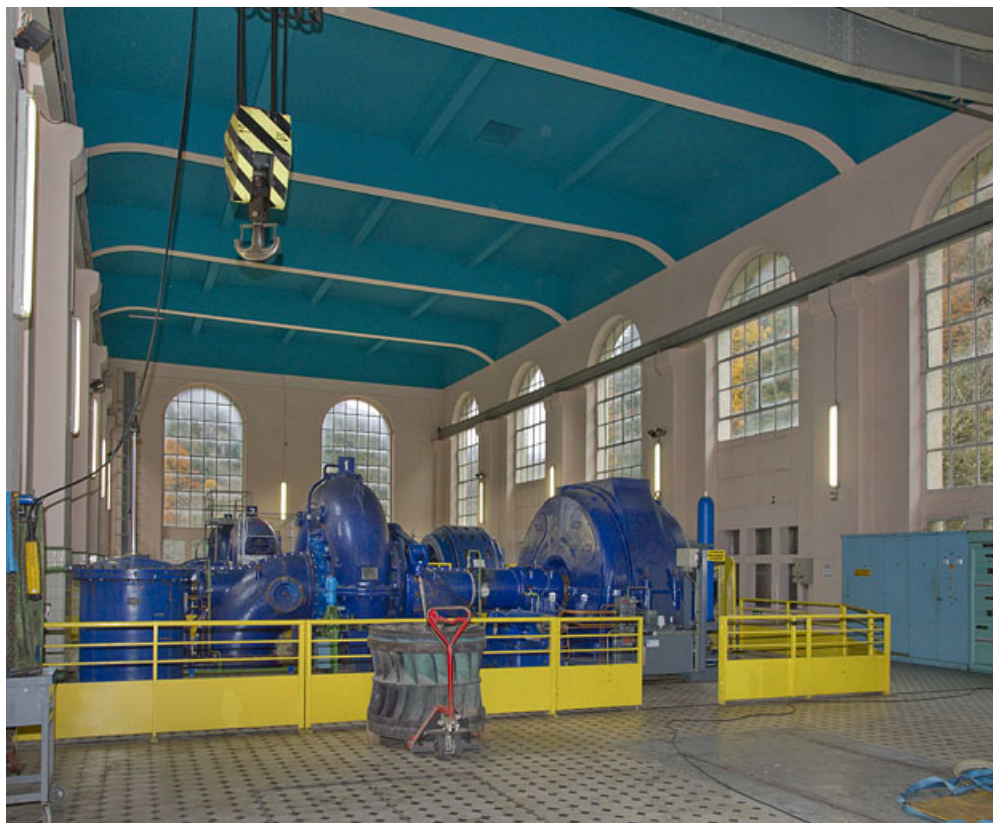
Centrale : intérieur de la salle des machines, de trois quarts. 25, Charquemont, lieudit : Mortier
