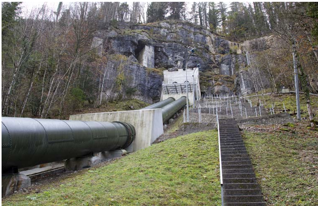
Conduite forcée : chambre de mise en charge et conduite depuis la centrale, vues de trois quarts. 25, Charquemont, lieudit : Mortier
