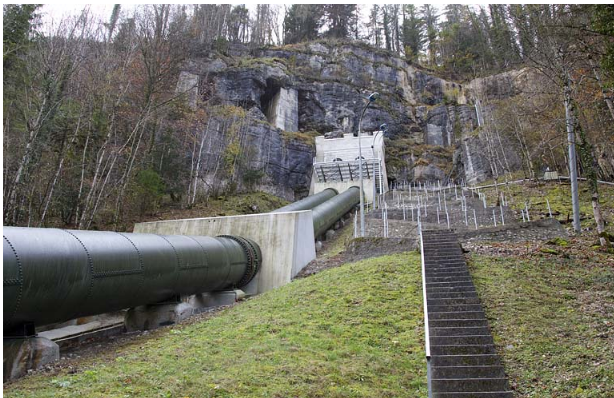
Conduite forcée : chambre de mise en charge et conduite depuis la centrale, vues de trois quarts. 25, Charquemont, lieudit : Mortier
