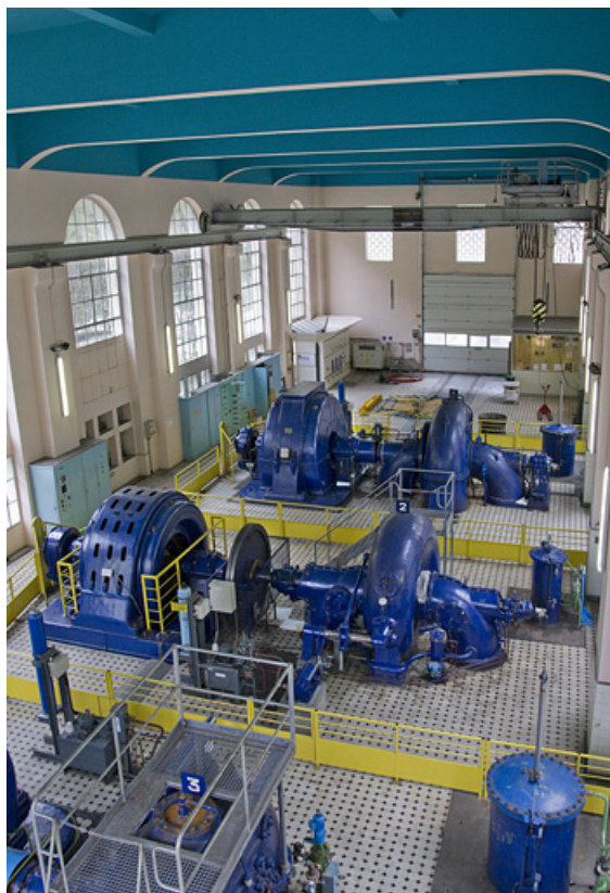
Centrale : vue plongeante à l'intérieur de la salle des machines.
