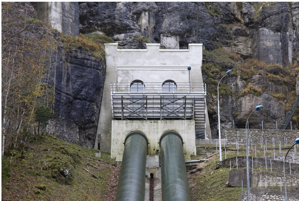
Conduite forcée : chambre de mise en charge.
