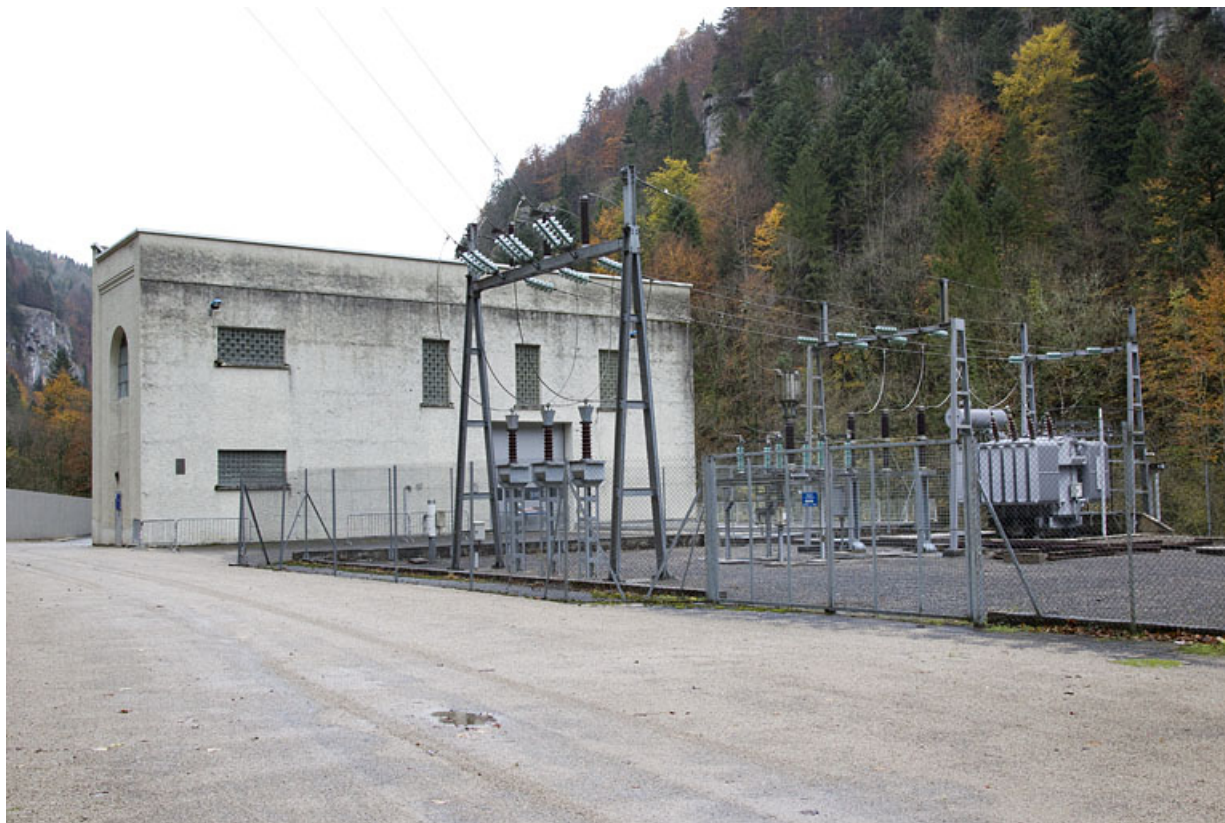
Centrale (façade antérieure) et transformateur.
