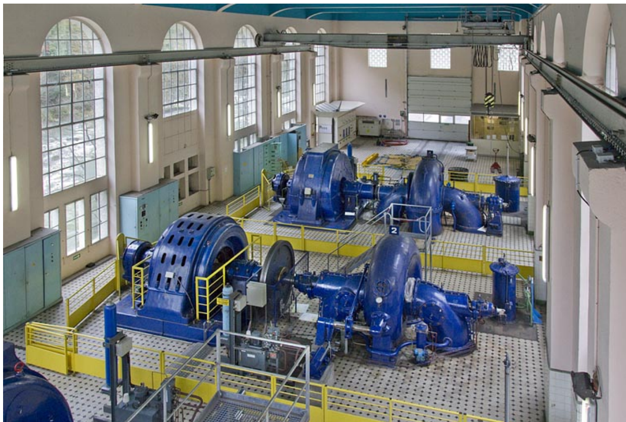
Centrale : vue plongeante à l'intérieur de la salle des machines.
