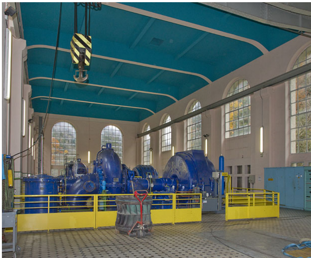
Centrale : intérieur de la salle des machines, de trois quarts. 25, Charquemont, lieudit : Mortier
