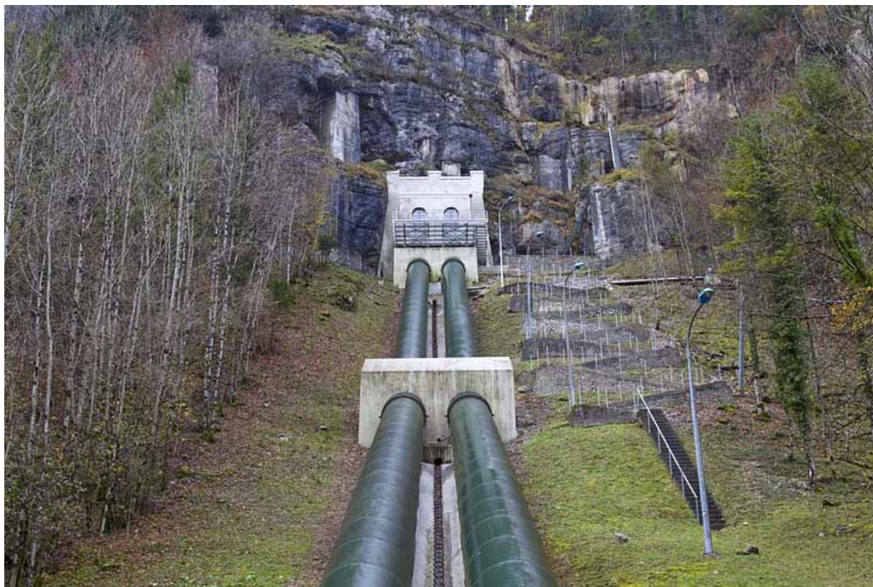
Conduite forcée : chambre de mise en charge et conduite, depuis la centrale. 25, Charquemont, lieudit : Mortier
