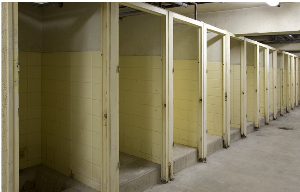
Bâtiment de l'hôtellerie (sous-sol) : bloc sanitaire désaffecté.
