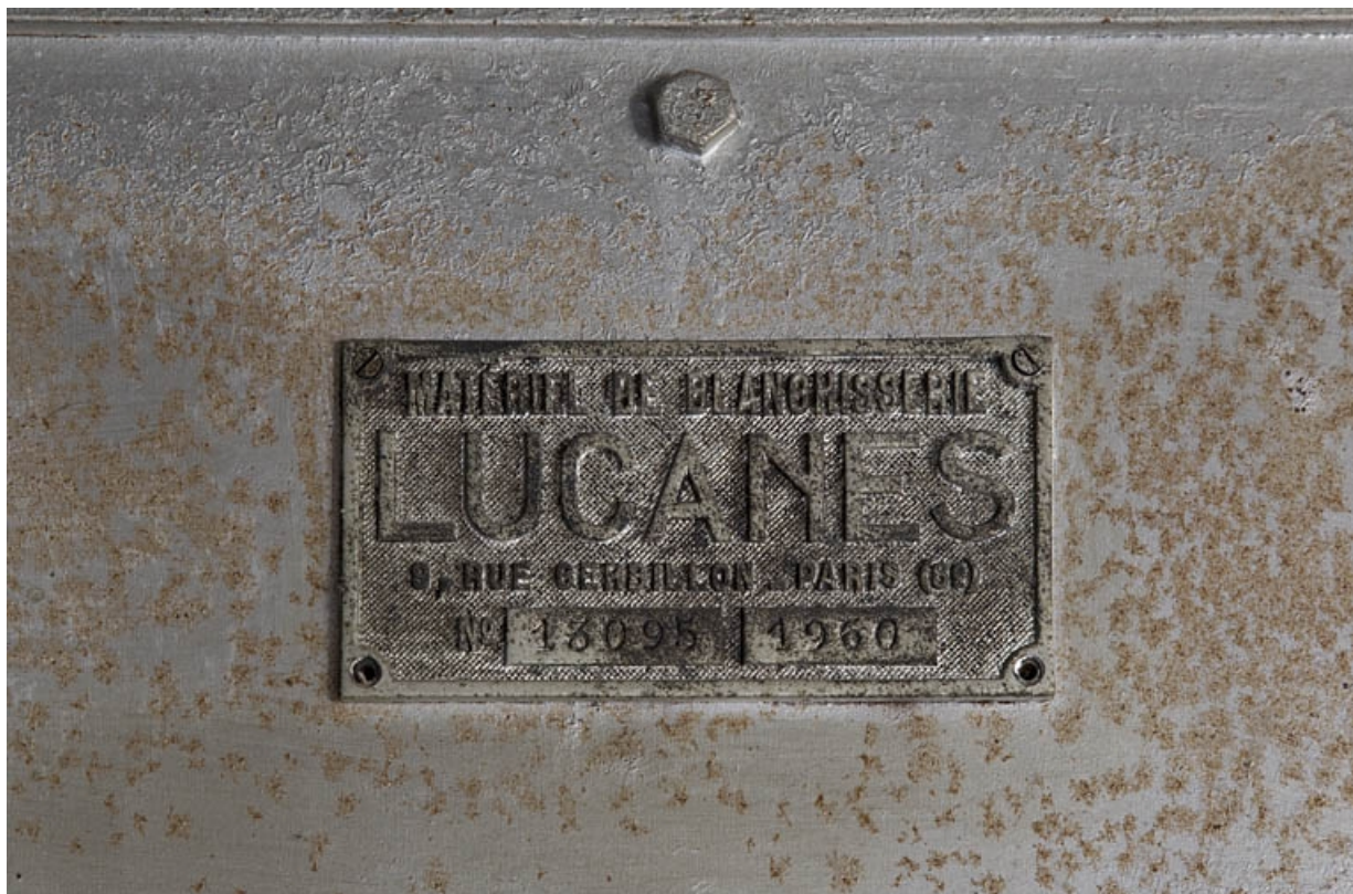
Bâtiment de l'hôtellerie (sous-sol) : plaque de constructeur du séchoir à gaz. 25, Pontarlier, 3 rue des Fusillés
