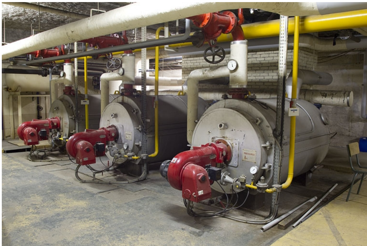
Externat (sous-sol), chaufferie : les chaudières.
