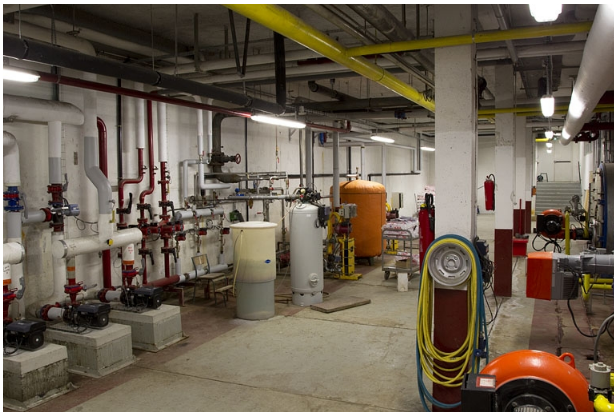
Bâtiment de l'internat ouest : vue d'ensemble de la chaufferie.
