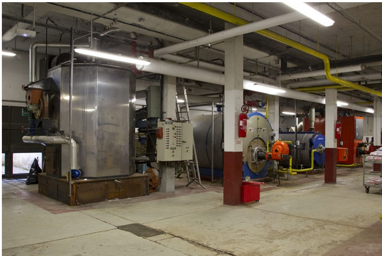
Bâtiment de l'internat ouest, chaufferie : les chaudières.
