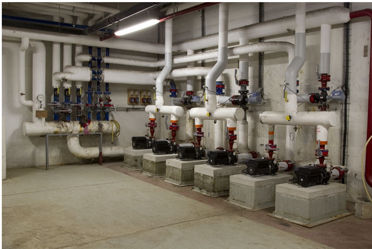
Bâtiment de l'internat ouest, chaufferie : les pompes.
