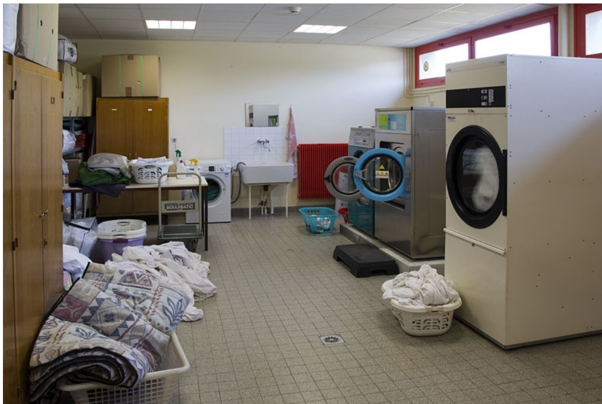
Bâtiment de l'internat ouest, lingerie : les machines à laver et à sécher. 25, Pontarlier, 53 rue de Doubs
