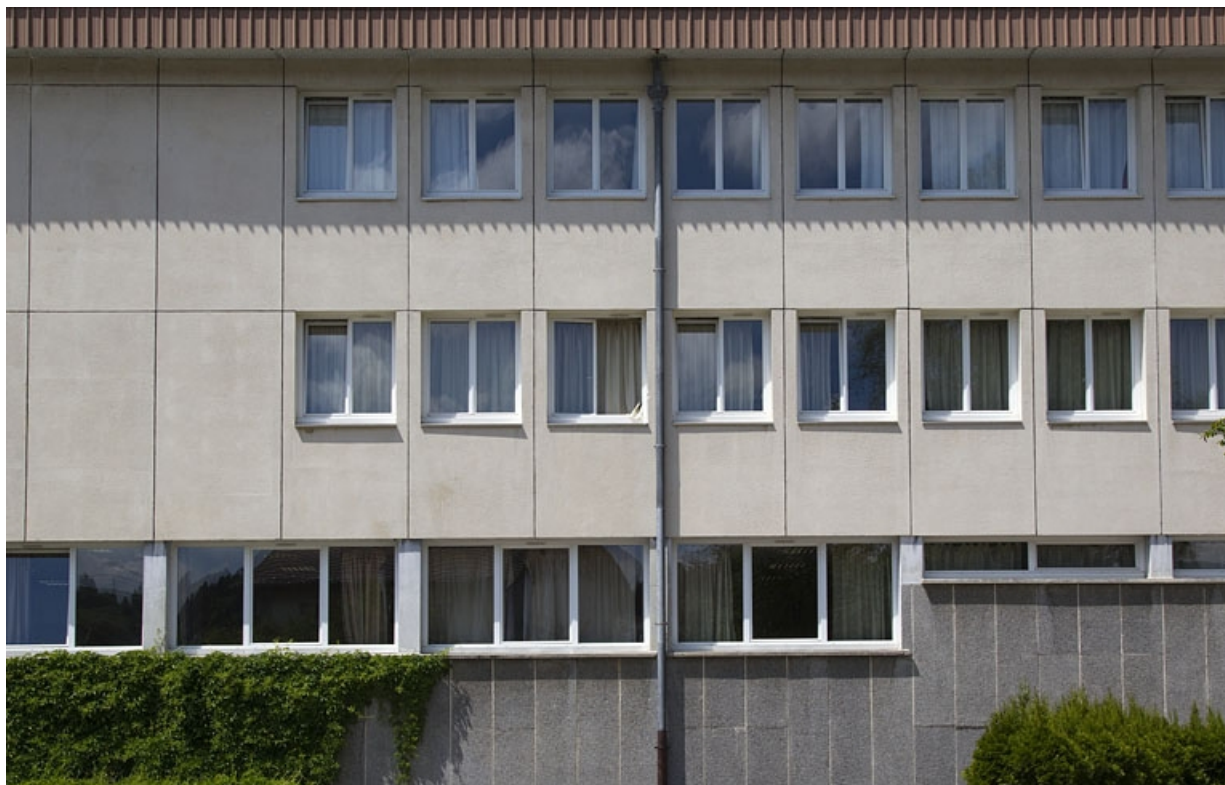
Ancien externat 1er cycle : détail du système constructif sur la façade antérieure.
