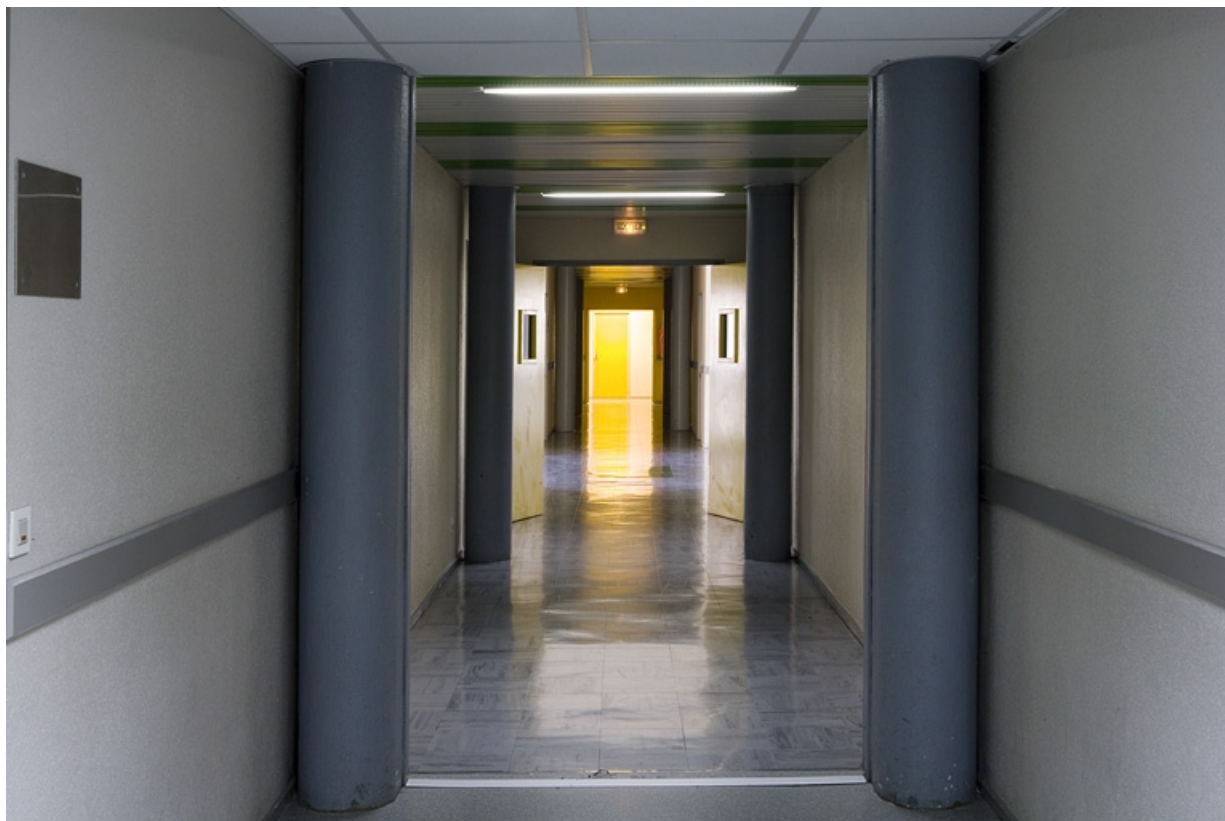
Site récent, bâtiment des laboratoires et du pôle bijouterie : couloir. 25, Morteau, 2 rue du Docteur Léon Sauze
