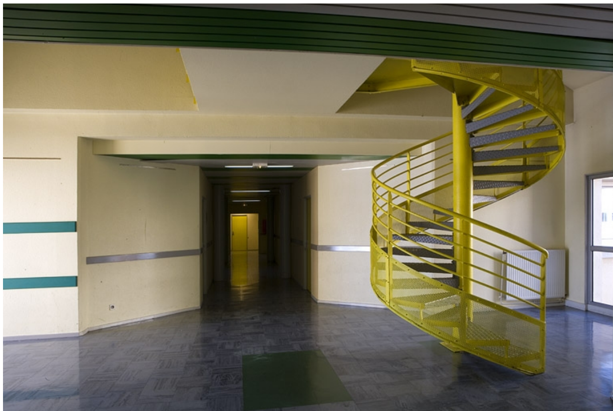
Site récent, bâtiment des salles d'informatique et du pôle bijouterie : escalier en vis reliant l'étage carré et l'étage en surcroît. 25, Morteau, 2 rue du Docteur Léon Sauze
