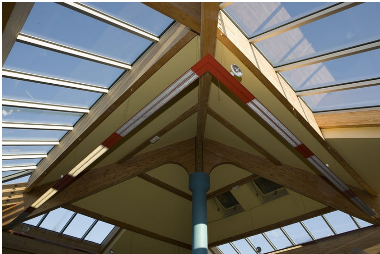
Site récent, centre de documentation (CDI) : charpente en lamellé-collé. 25, Morteau, 2 rue du Docteur Léon Sauze
