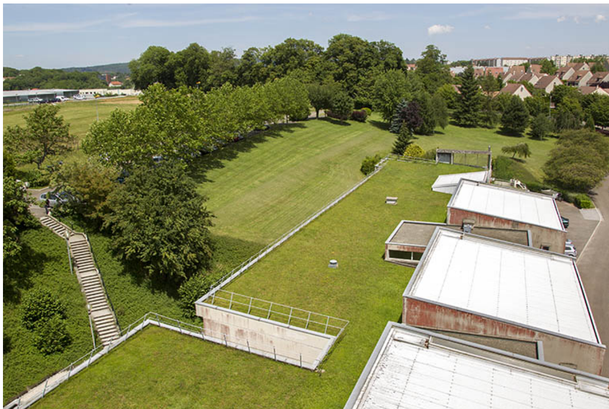
Détail de toiture et escalier indépendant desservant la façade postérieure au nord.
