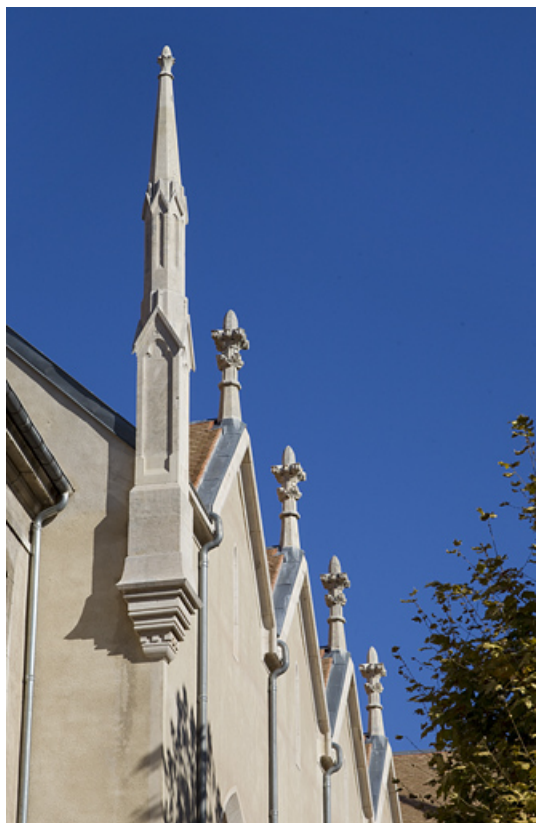
Pinacles de la façade sud de la chapelle surmontant chaque travée. 25, Besançon, 4 rue du Lycée
