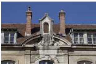
Vue rapprochée du fronton surmontant la travée centrale de la façade antérieure du bâtiment Ducat.
