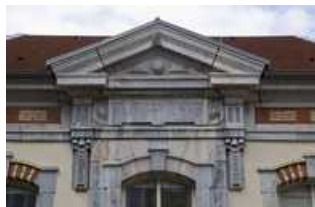
Fronton surmontant la travée centrale de l'infirmérie située dans la deuxième cour du bâtiment Ducat.
