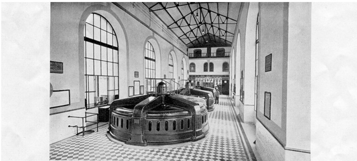
USINE DU CHATELOT : Salle des machines comprenant 3 groupes turbines et alternateurs de 1.000 CV chacun et 1 condensateur synchrone de 625 KVA.
