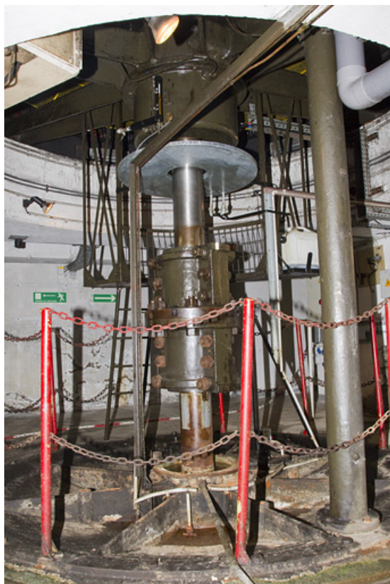
Détail de la transmission verticale d'une turbine.
