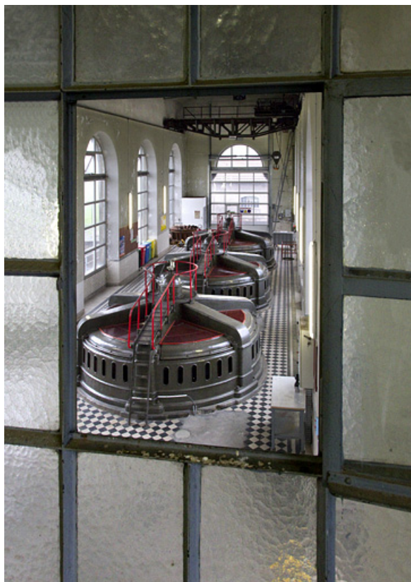
Vue plongeante sur la salle des machines.
