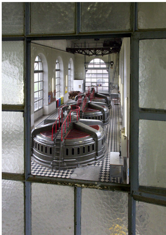
Vue plongeante sur la salle des machines.
