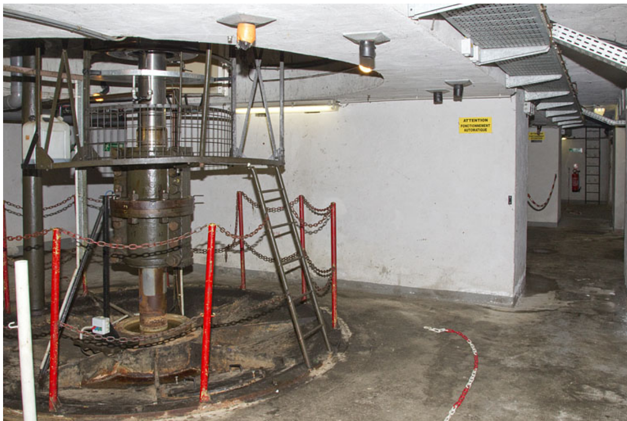
Etage inférieur de la salle des machines. Partie supérieure d'une turbine.
