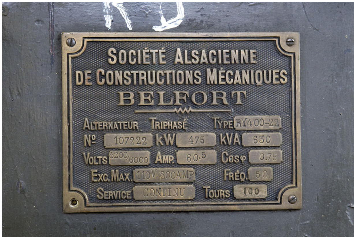
Plaque de constructeur d'un alternateur SACM.
