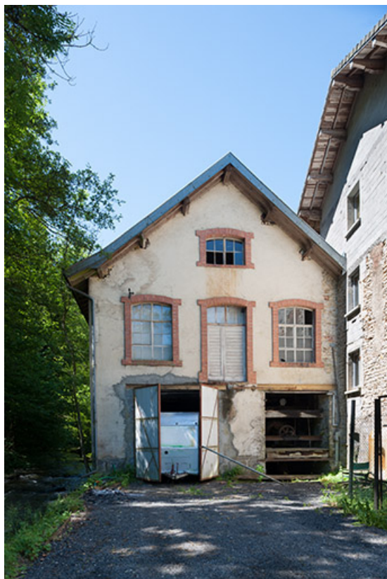
Pignon est de l'atelier de quincaillerie. La turbine est visible à droite, à l'étage de soubassement. 25, Feule, lieudit : le moulin de chez la Dinette
