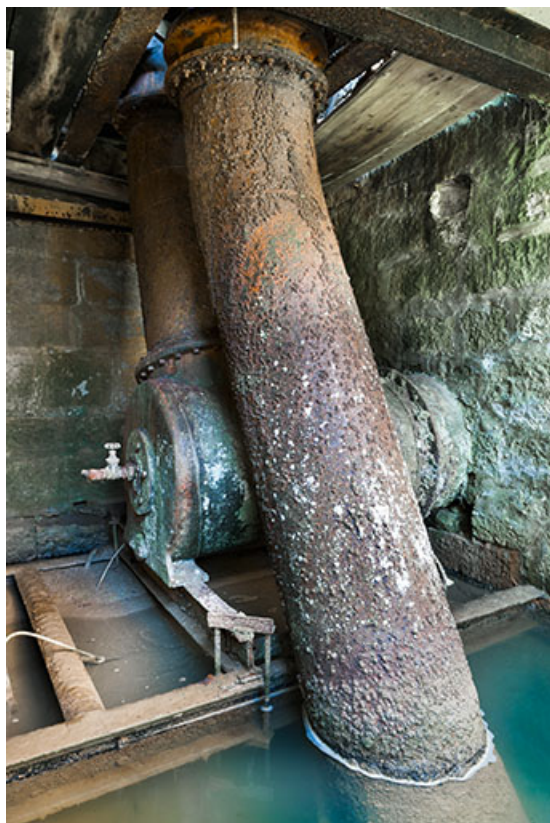
Turbine hydraulique (partie inférieure).
