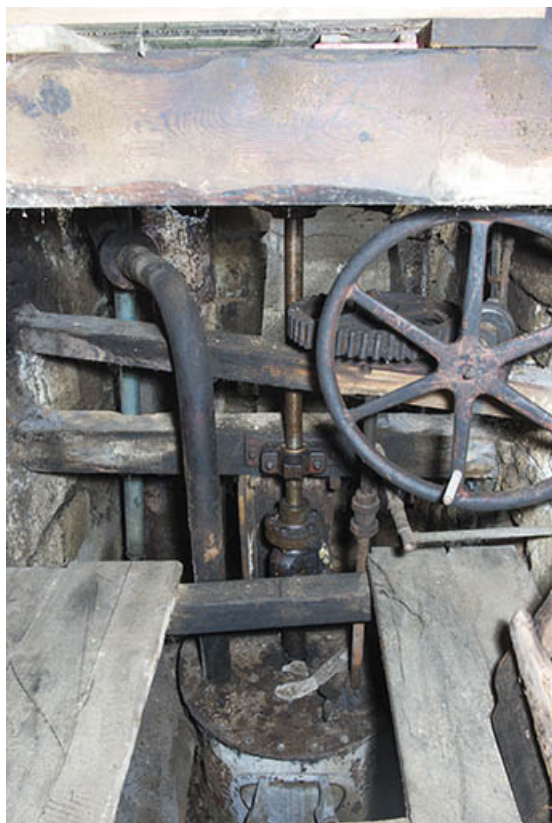
Mécanisme de débrayage de la turbine (visible en bas). 25, Rémondans-Vaivre, 14 rue du Moulin
