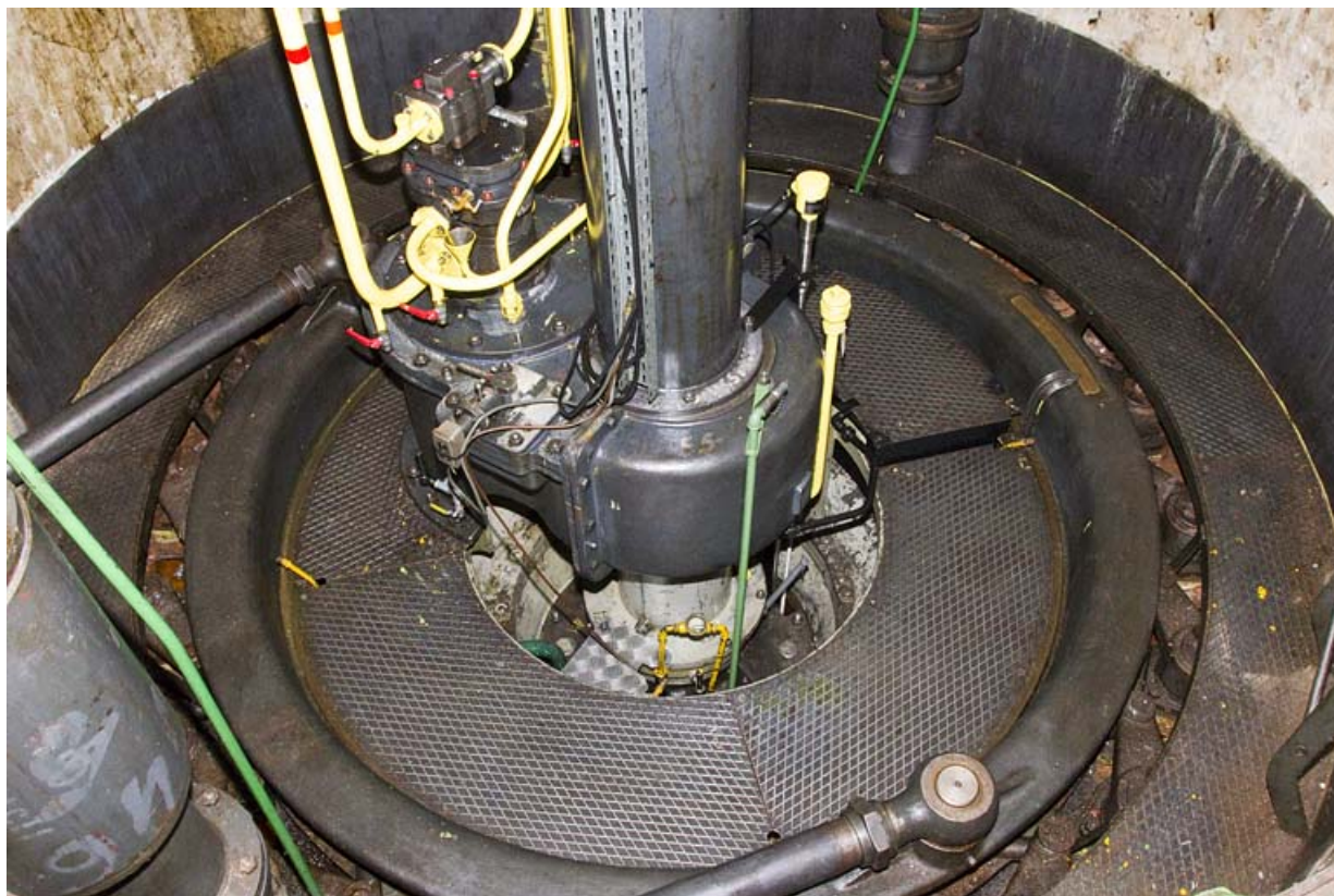
Partie supérieure d'une turbine et axe de transmission vertical.
