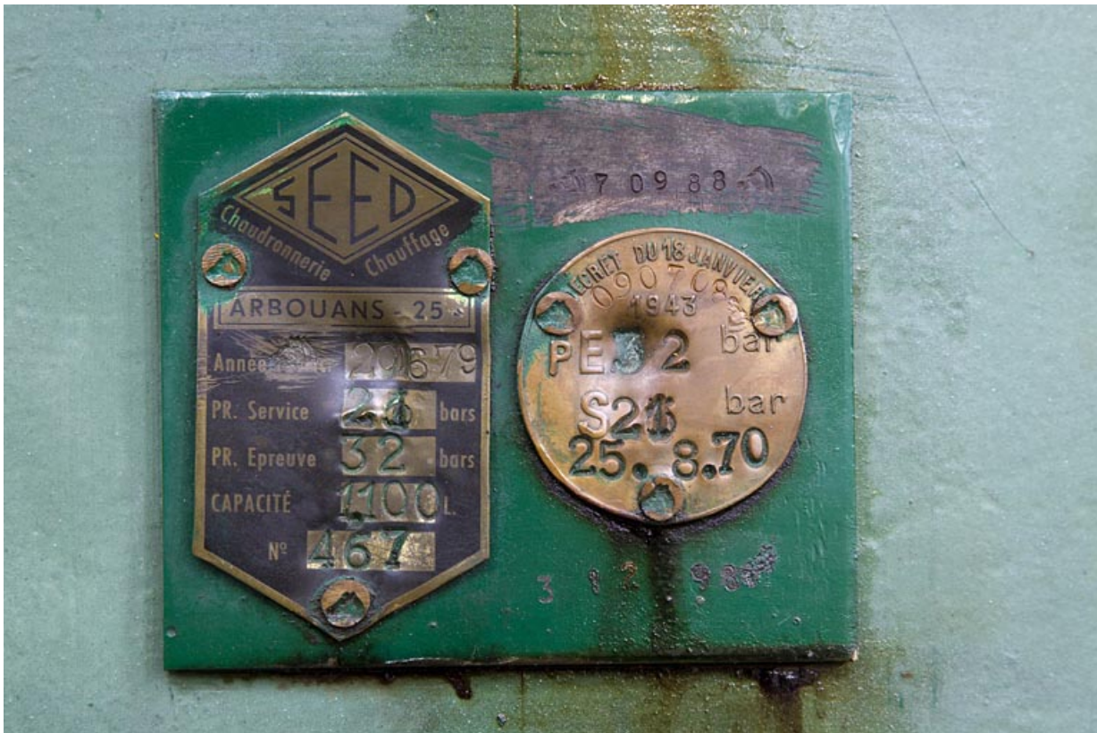
Réservoir d'air comprimé. Plaque d'épreuve. 25, Noirefontaine, lieudit : le Poset
