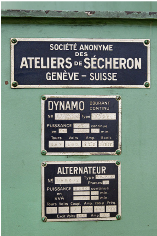
Plaque de constructeur de l'alternateur. 25, Noirefontaine, lieudit : le Poset
