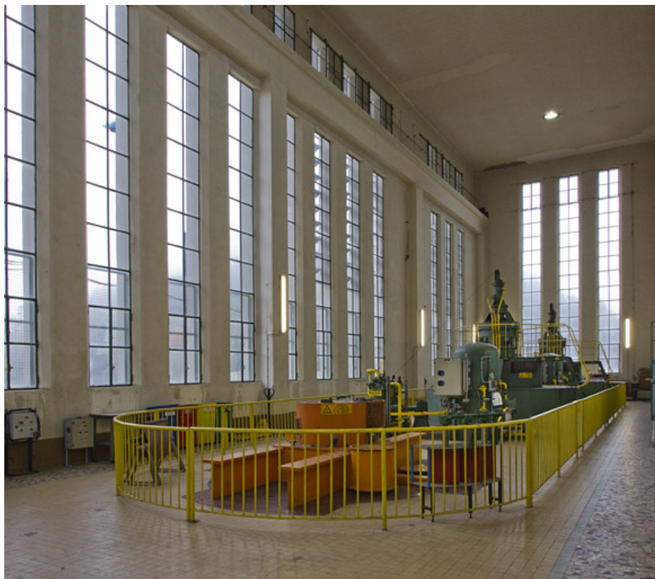
Vue d'ensemble de la salle des machines.
