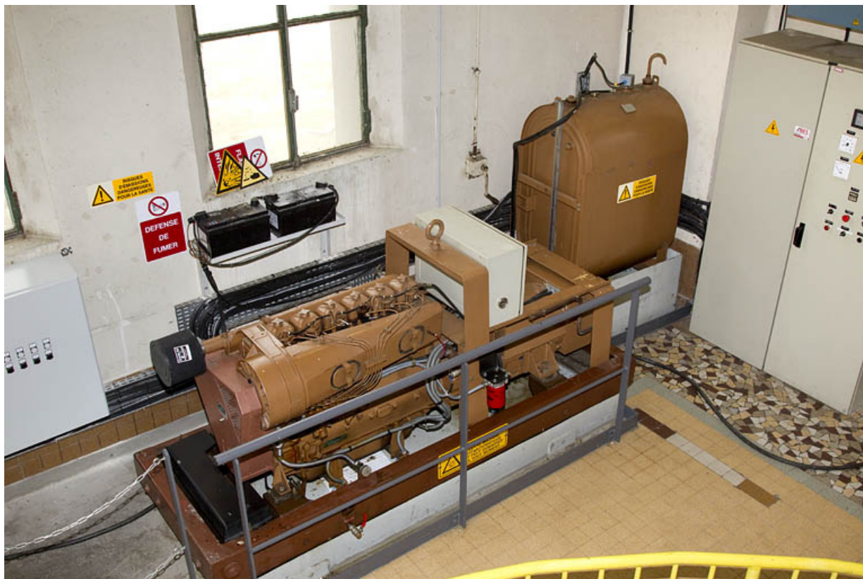
Groupe électrogène de secours (commande du vannage).
