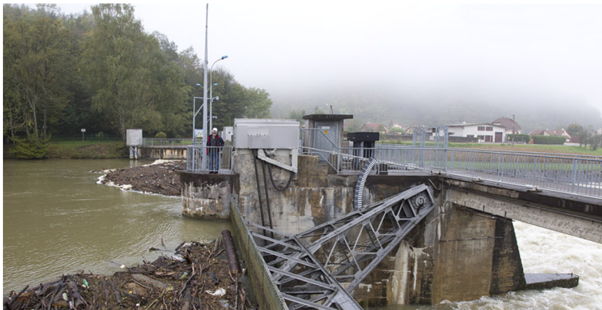
Vannage sur le barrage . Vanne clapet de surface au premier plan.
