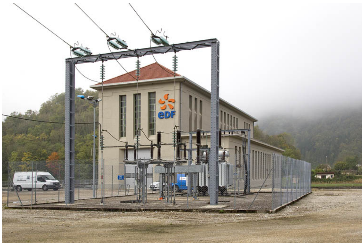
Bâtiment de la centrale et poste de transformation électrique.
