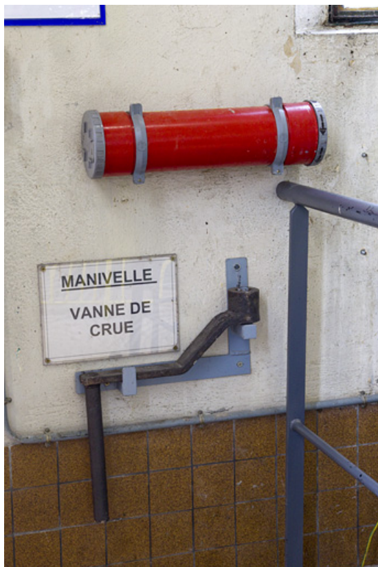
Manivelle de secours (commande du vannage).
