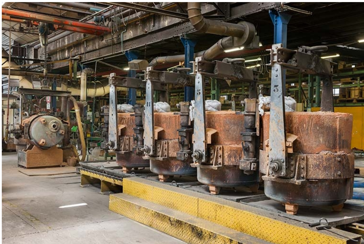
Poches de coulée avant réfection (1). 25, Colombier-Fontaine, 2 rue du Doubs
