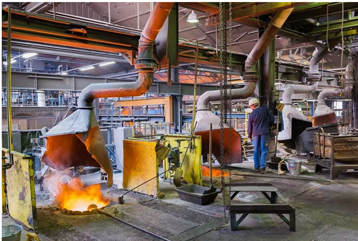
Partie supérieure des fours à induction.
