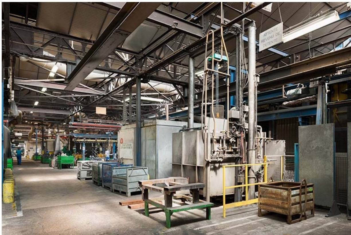
Vue d'ensemble. Four de traitement thermique.
