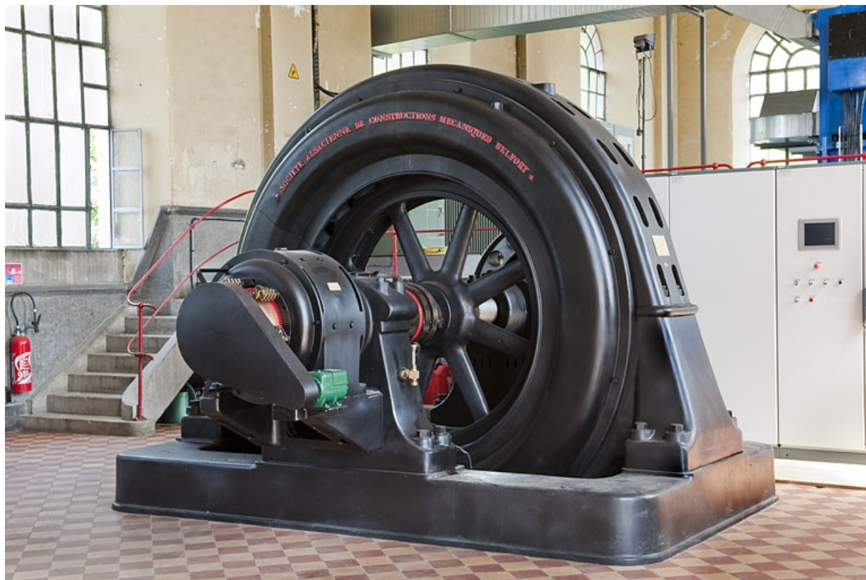
Alternateur de la Société Alsacienne de Constructions Mécaniques (Belfort). 25, Mathay, lieudit : rue du Barrage
