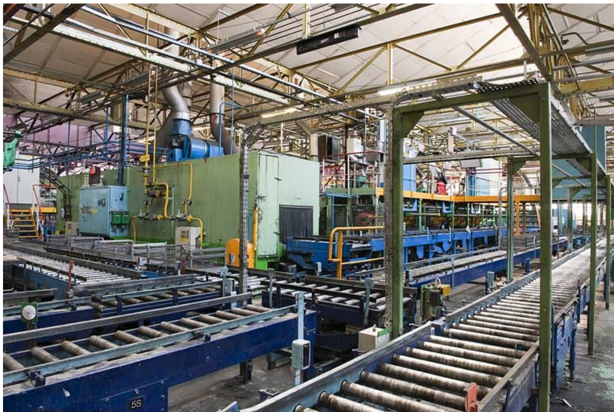
Atelier de rénovation des moteurs. Chaîne désaffectée.
