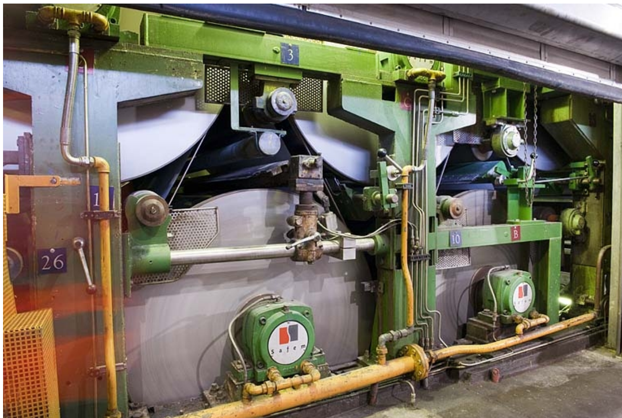
Machine à papier. Vue rapprochée de la partie séchage.
