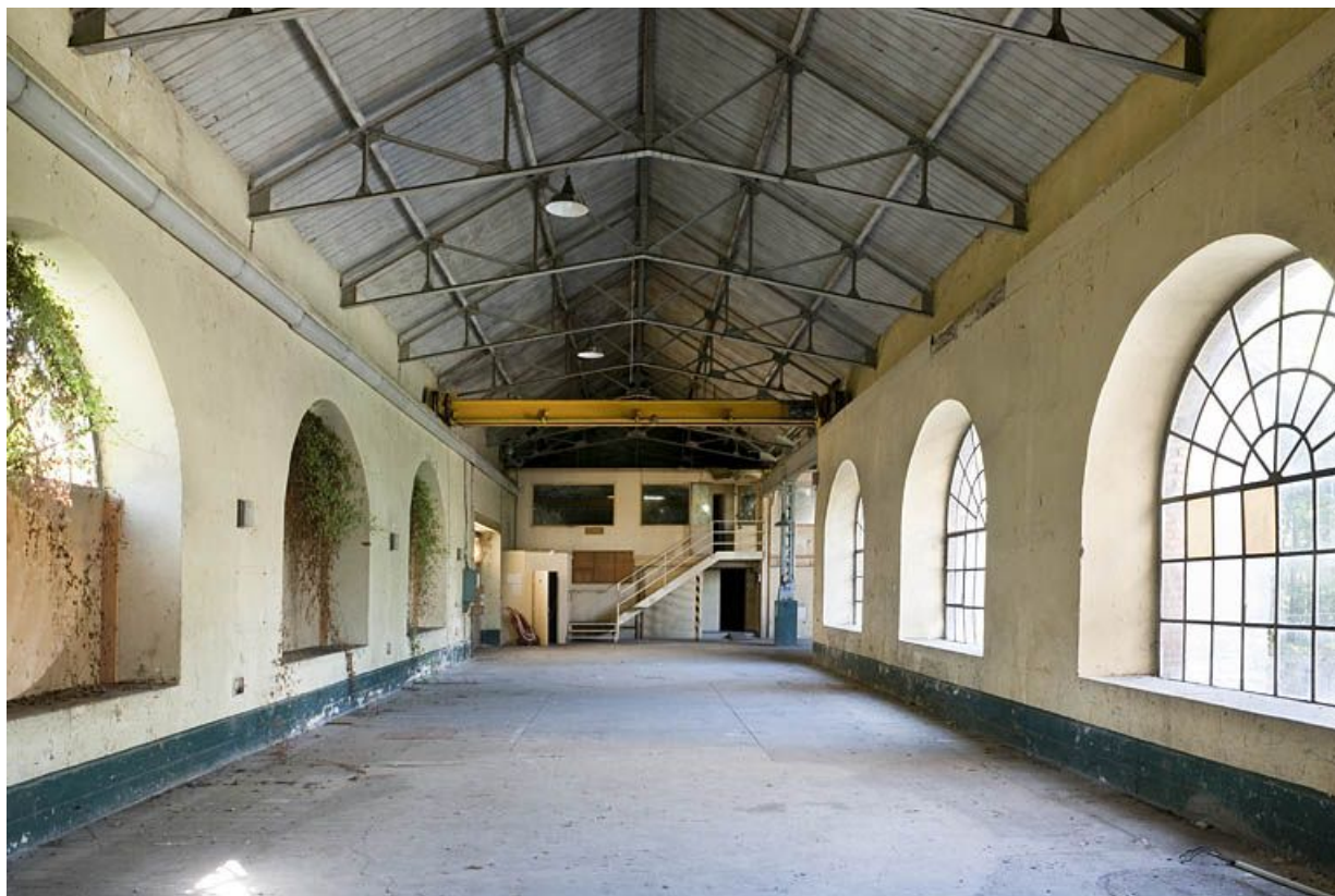
Vue intérieure de la salle des turbines.
