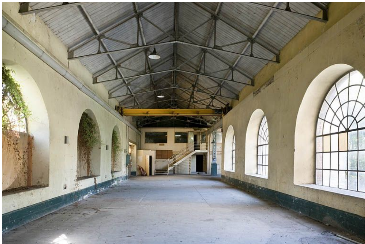
Vue intérieure de la salle des turbines.
